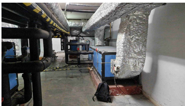
Fig. 7.1.B. Climatizador CLI-15 en sala técnica de planta de sótano
