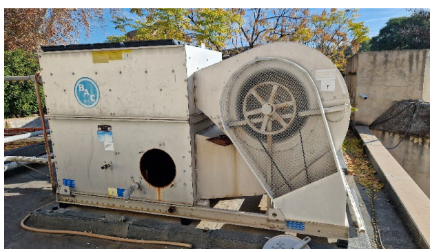
Fig. 3.3.C. Torre de refrigeración obsoleta.
