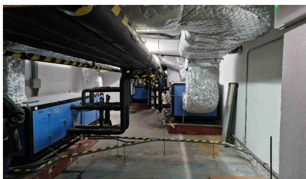
Fig. 4.1.A. Sala de climatizadores CLI-11, CLI-13 y CLI-09 en planta de sótano
