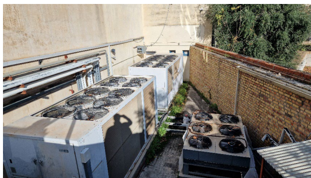
Fig. 3.3.B. Condensadora obsoleta (la situada a la derecha en la imagen)
