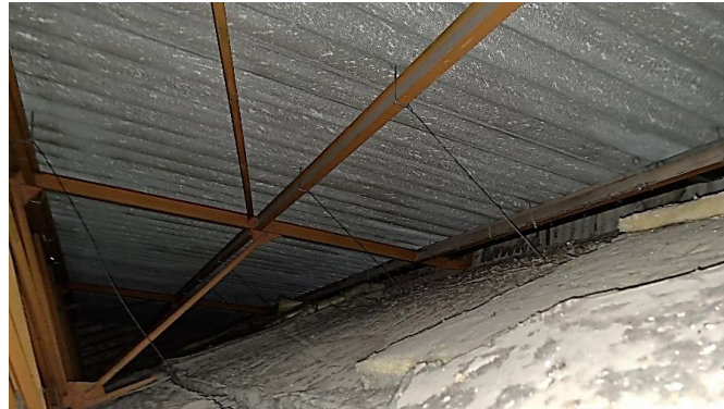
Imagen en la que se aprecia la existencia de mantas de lana mineral sobre las chapas onduladas galvanizadas
