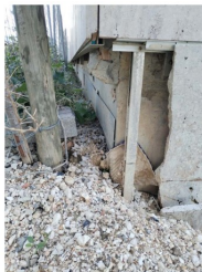
Deterioro del revestimiento en zonas en contacto con el terreno
