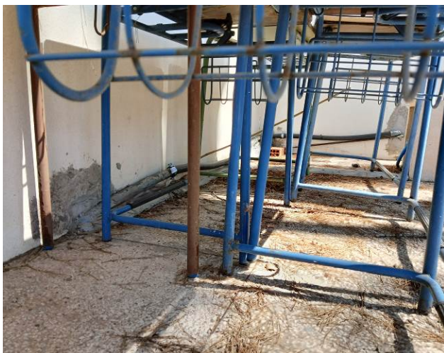
Conducciones de agua potable y residuales en la fachada este
