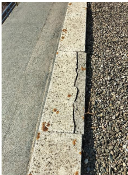
Roturas zabaletas cubierta planta alta
