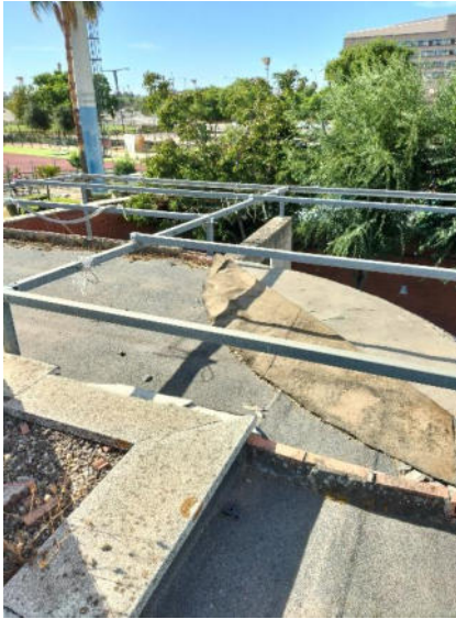
Impermeabilización cornisas deterioro
