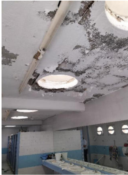
Humedades cubierta planta alta
