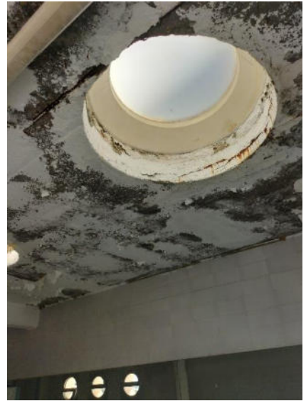
Humedades en entorno claraboyas
