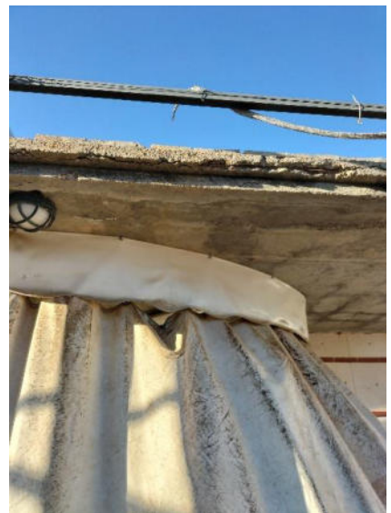
Patologías cornisas planta alta
