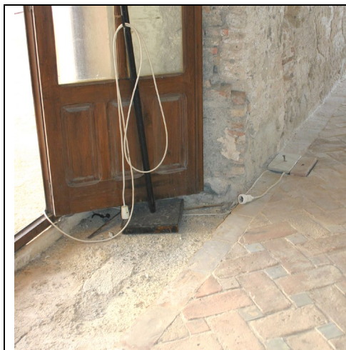
Muestra de la red eléctrica existente. Embutida en el suelo con registros accesibles presenta tomas improvisadas a causa del uso.
