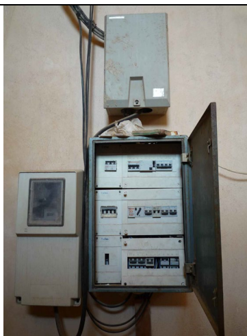
Actual cuadro general de protección – en la bodega- que se renueva completamente según proyecto.
