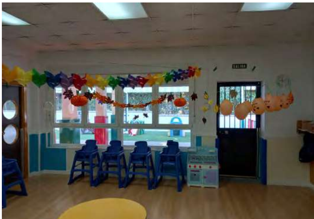
F08: Carpinterías a sustituir
