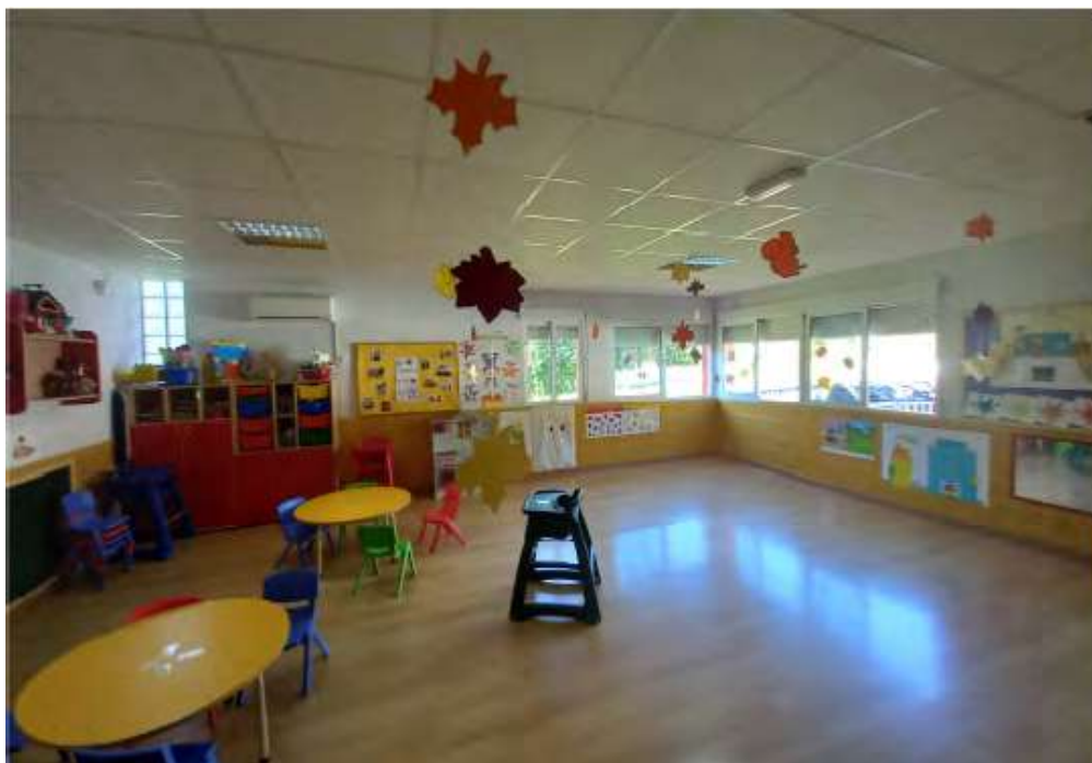
F07: Carpinterías a sustituir
