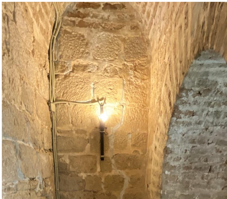
Detalle de instalaciones de electricidad e iluminación vistas
