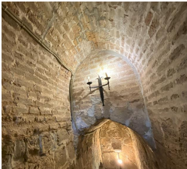
Detalle de instalación eléctrica vista
