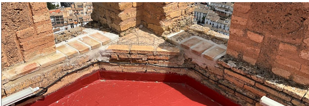
Detalle. Reparaciones y parcheados en una de las esquinas
