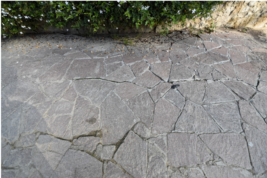
18. Detalle del hundimiento del pavimento junto a la base del muro que produce retención y acumulación de agua.
