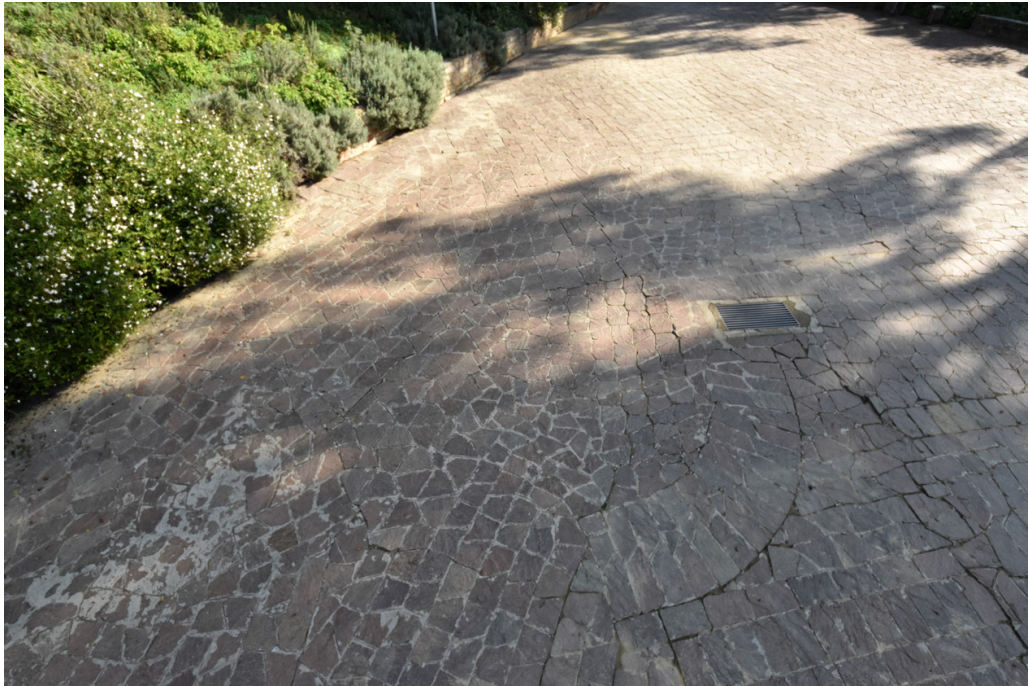
21. Zona del pavimento alrededor el imbornal hundida donde se acumula el agua.
