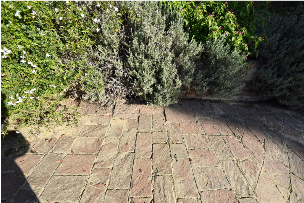
19. Levantamiento del pavimento junto a la base del muro con mayor desplome producido por el giro del muro.
