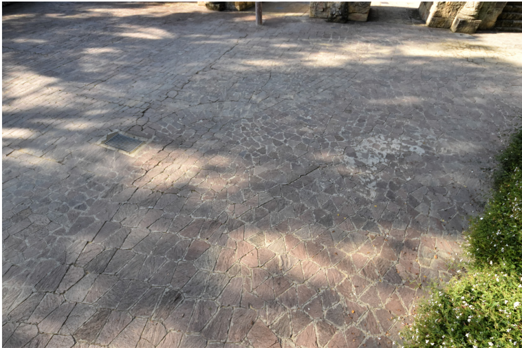
22. Vista de la misma zona con hundimiento del pavimento alrededor del imbornal
