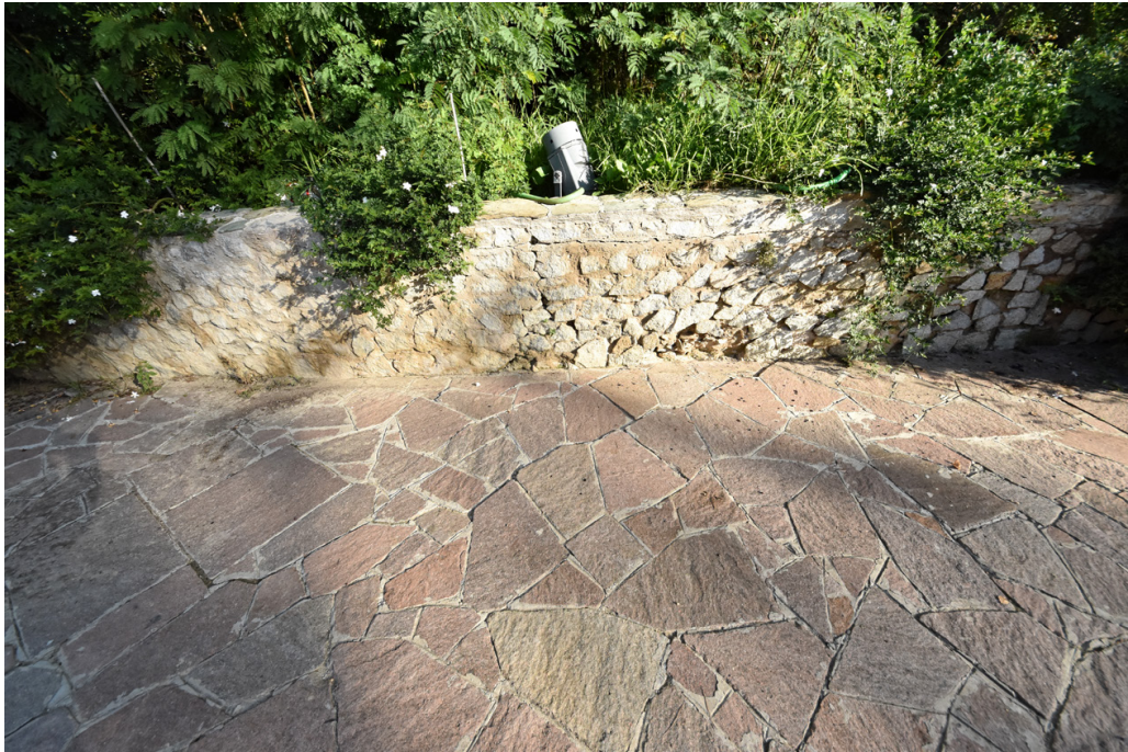
17. Detalle de grieta en el tramo central del muro.
