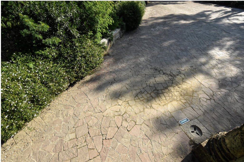
20. Zona del pavimento en el interior de la explanada hundida donde se acumula el agua.
