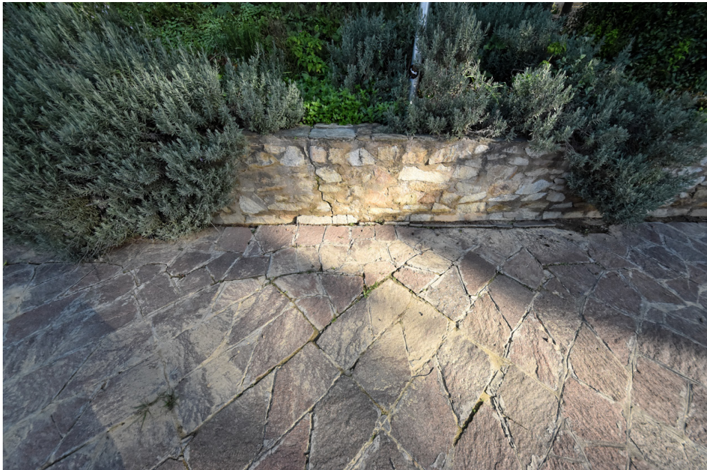
16. Detalle de una grieta en el tramo central del muro.
