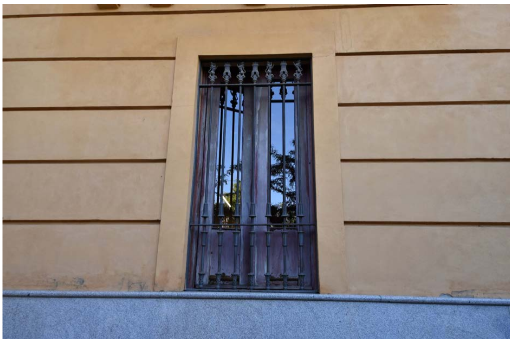
30. Ventana en planta baja de la fachada oeste afectada por la humedad. Se puede ver la decoloración y el mal estado de la parte inferior de la ventana
