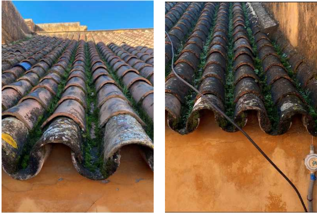
98. y 99. Detalle de vegetación y musgo en las cubiertas
