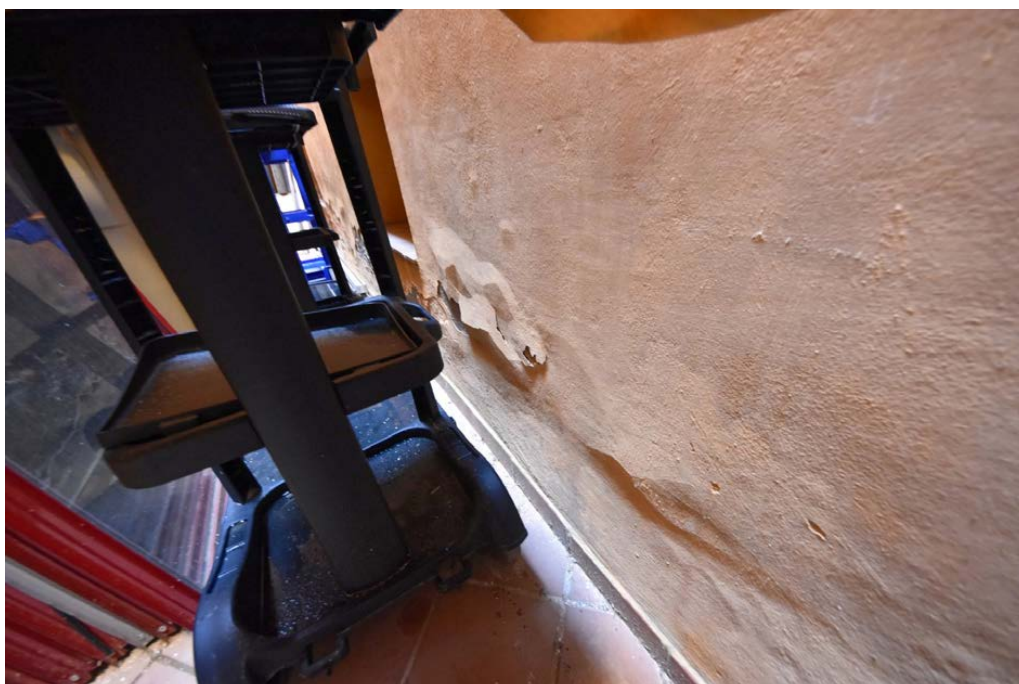
68. Fachadas interiores del patio 4. Se puede ver el mal estado del mortero en la parte inferior de los muros con abofados y desprendimientos
