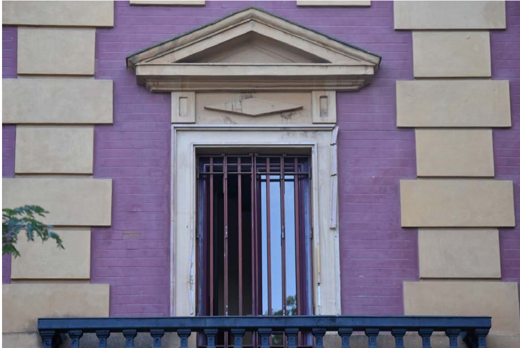
39. Ventana en planta alta de la fachada oeste. Se puede ver el desprendimiento de las molduras y la pérdida de algunos elementos del recercado de hueco
