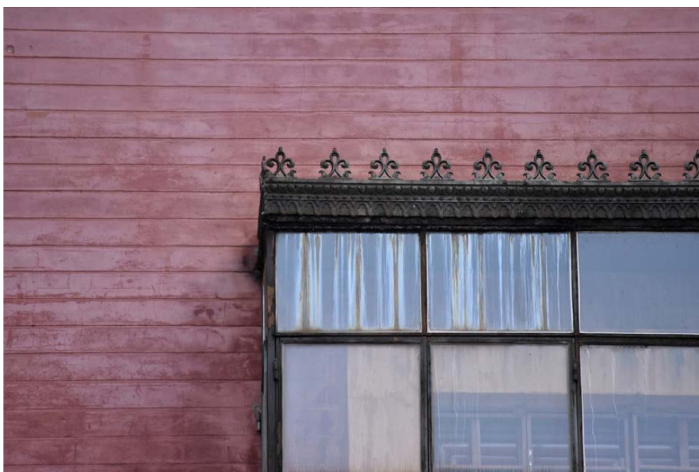
85. Detalle del cierre de planta alta de la fachada a la plaza de la Concordia. Se puede ver algunas oxidaciones y mal estado de la pintura
