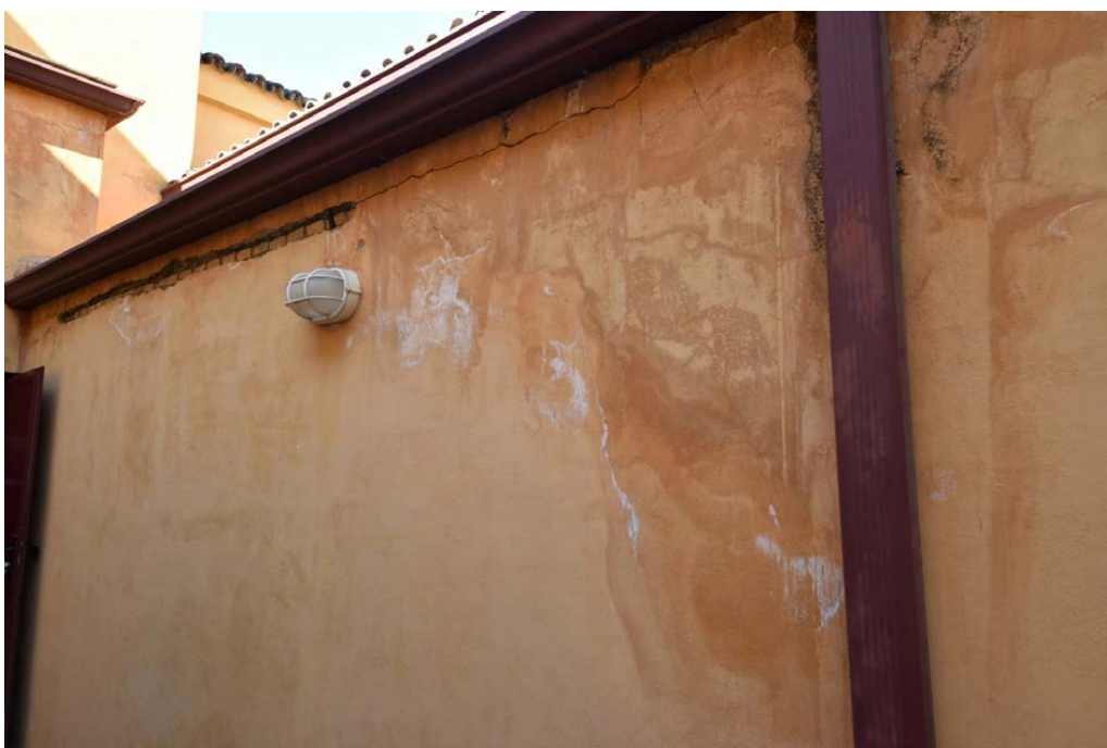
77. Canalón de la fachada oeste del patio 3. Se puede las manchas de humedad y las fisuras en el revestimiento originadas por el mal funcionamiento del canalón
