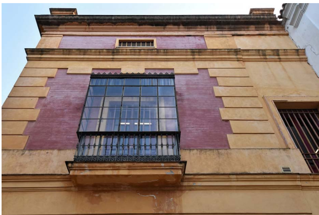
61. Fachada a la plaza de la Concordia. Se puede ver las manchas de verdín y ennegrecidos por líquenes y musgos, en la parte baja de cornisas y molduras, provocados por la escorrentía del agua de lluvia por falta de goterón
