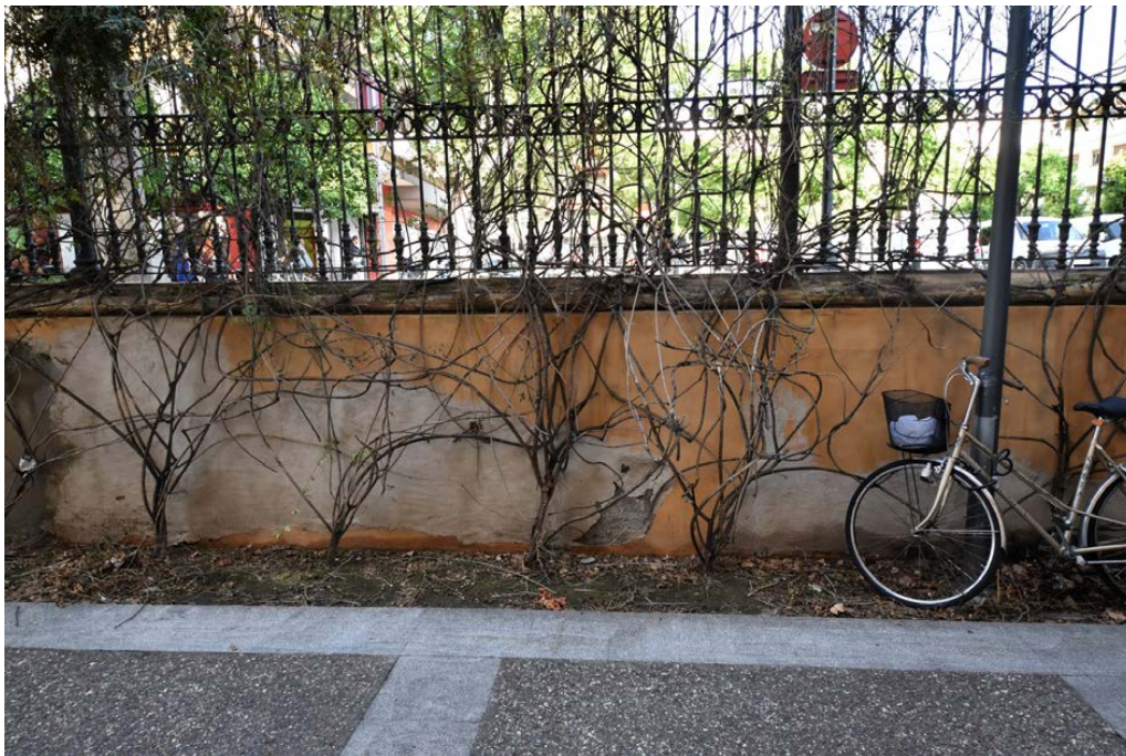
53. Cara interior del cerramiento a la plaza de la Gavidia. Se puede ver el mal estado del mortero de revestimiento, que presenta disgregaciones, fallos de adherencia, abofados y desprendimientos
