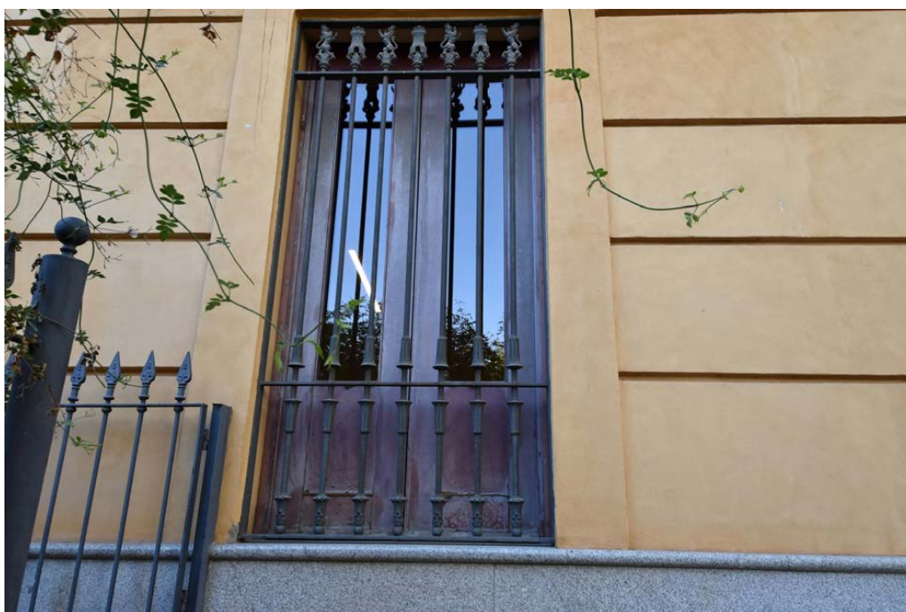
31. Ventana en planta baja de la fachada oeste afectada por la humedad
