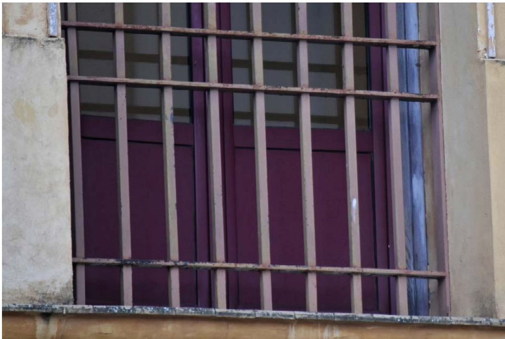
86. Detalle de reja de planta alta de la fachada a la plaza de la Concordia. Se puede ver algunas oxidaciones y mal estado de la pintura
