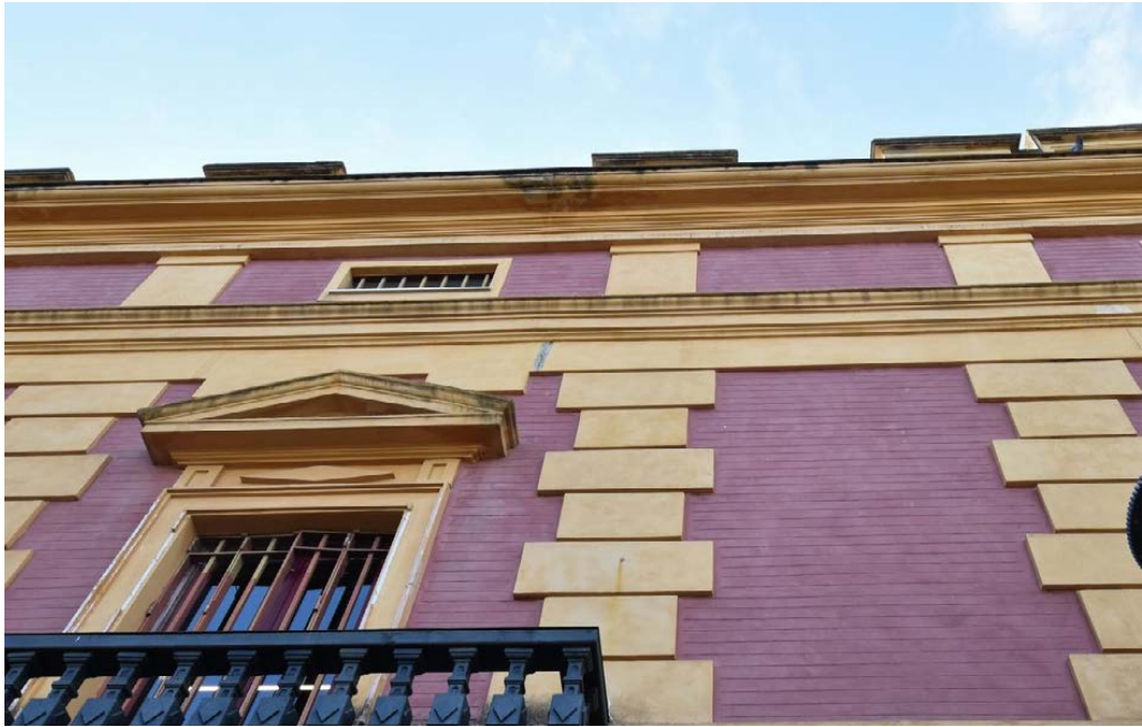
58. Fachada a la plaza de la Gavidía. Se puede ver las manchas de verdín y ennegrecidos por líquenes y musgos, en la parte baja de cornisas y molduras, provocados por la escorrentía del agua de lluvia por falta de goterón
