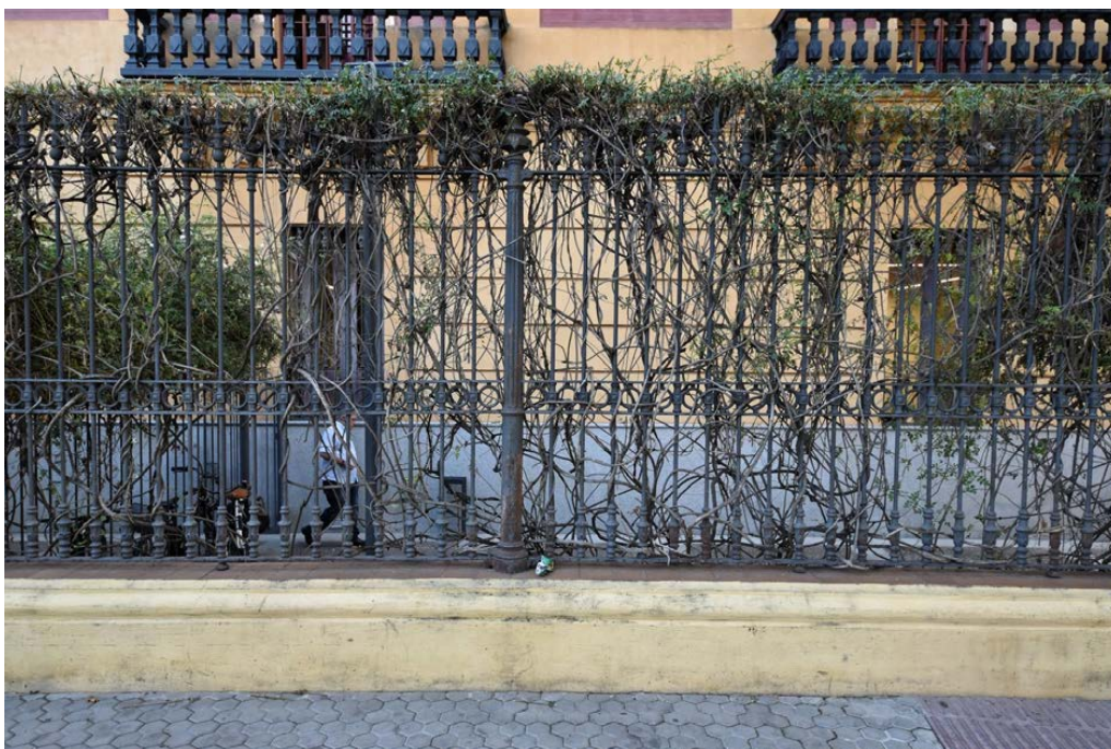
87. Elementos metálicos del cerramiento del jardín a la plaza de la Gavidia con mal estado de la pintura y oxidaciones en algunos puntos.
