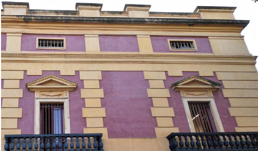
59. Fachada a la plaza de la Gavidía. Se puede ver las manchas de verdín y ennegrecidos por líquenes y musgos, en la parte baja de cornisas y molduras, provocados por la escorrentía del agua de lluvia por falta de goterón
