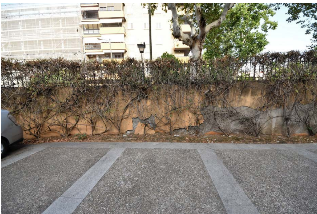
54. Cara interior del cerramiento a la plaza de la Gavidia. Se puede ver el mal estado del mortero de revestimiento, que presenta disgregaciones, fallos de adherencia, abofados y desprendimientos
