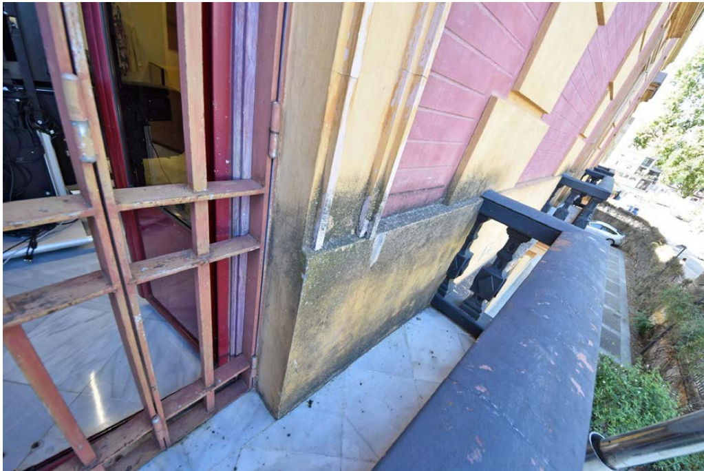
36. Detalle de una ventana en planta alta de la fachada oeste. Se puede ver el marco de madera afectada por la humedad.
