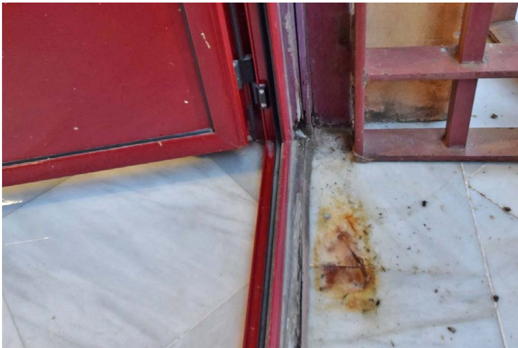
37. Detalle del marco inferior de una ventana en planta alta de la fachada oeste. Se puede ver la deformación de la madera y las oquedades por pudrición en la esquina
