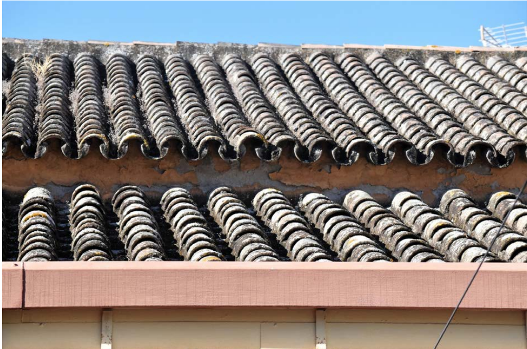
71. Cambio de nivel en la cubierta del patio 1. Se puede ver el mal estado del revestimiento de mortero que presenta abofados y desprendimientos.
