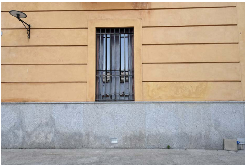
32. Ventana en planta baja de la fachada oeste afectada por la humedad. Se puede ver la decoloración y el mal estado de la parte inferior de la ventana
