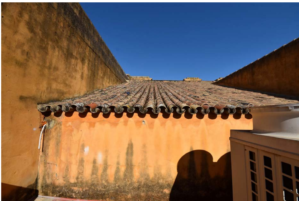
79. Alero de la cubierta en el patio 5. Se puede las manchas de humedad y mal estado del revestimiento originados por la falta de canalón
