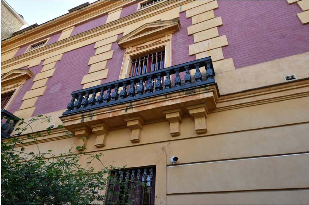
50. Balcón de planta alta de la fachada a la plaza de la Gavidía. Se puede ver las manchas de humedad y verdín provocados por la entrada de agua de lluvia
