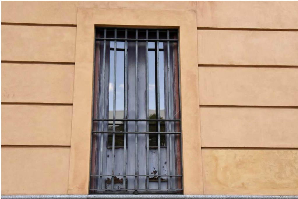
80. Reja de planta baja de la fachada a la plaza de la Gavidía. Se puede ver algunas oxidaciones y mal estado de la pintura
