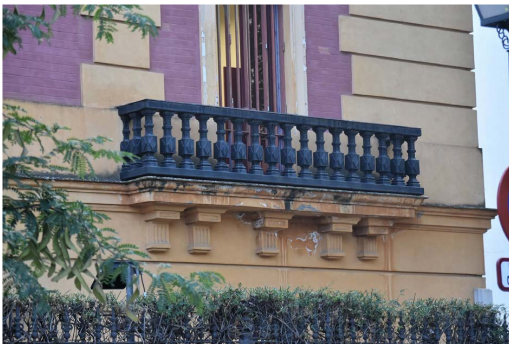
49. Balcón de planta alta de la fachada a la plaza de la Gavidía. Se puede ver las manchas de humedad, sales y verdín provocados por la entrada de agua de lluvia
