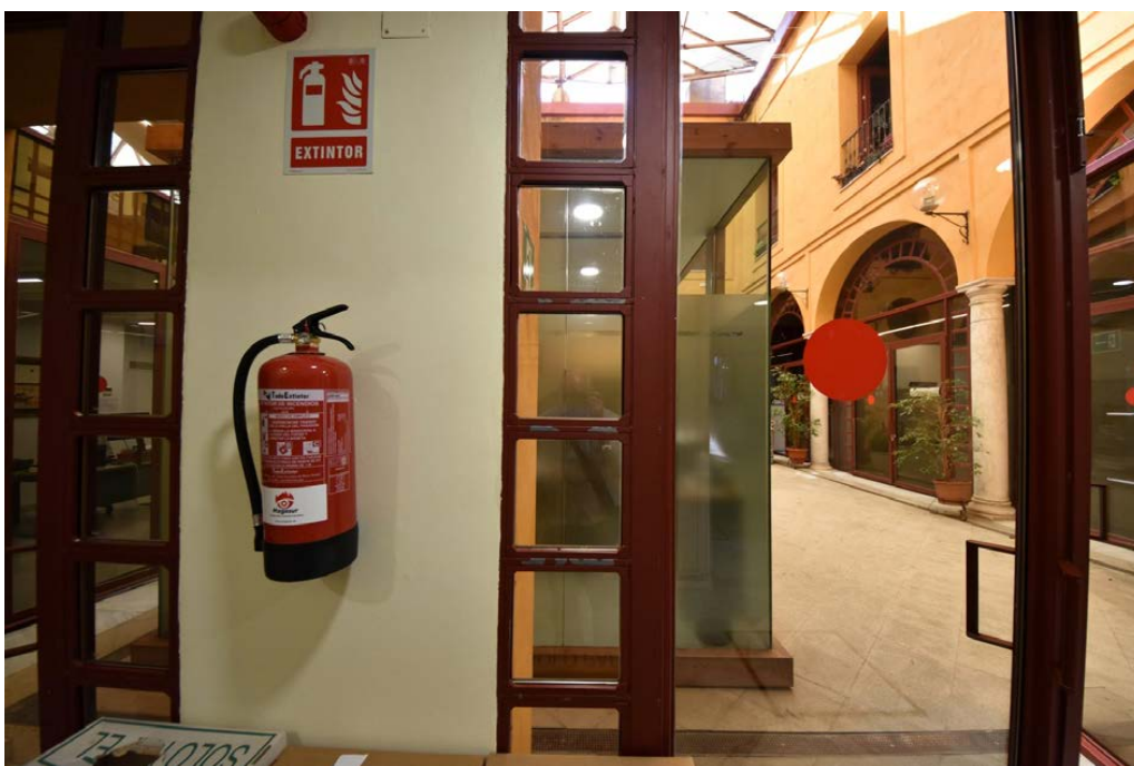
89. Detalle de carpintería metálica de la planta baja al patio 2. Se puede observar deterioro y el desprendimiento de la pintura en los perfiles horizontales
