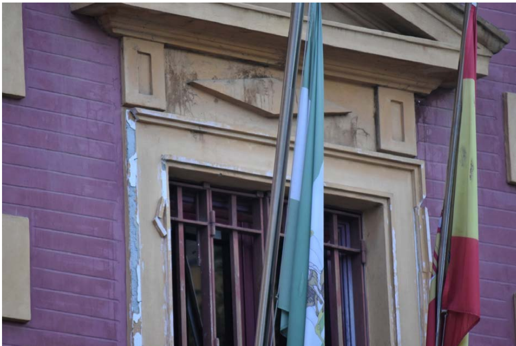
40. Detalle de una ventana en planta alta de la fachada oeste. Se puede ver el desprendimiento de las molduras y en las zonas con pérdidas conserva la pintura por lo que parece que las molduras se colocaron después de pintar los recercados.
