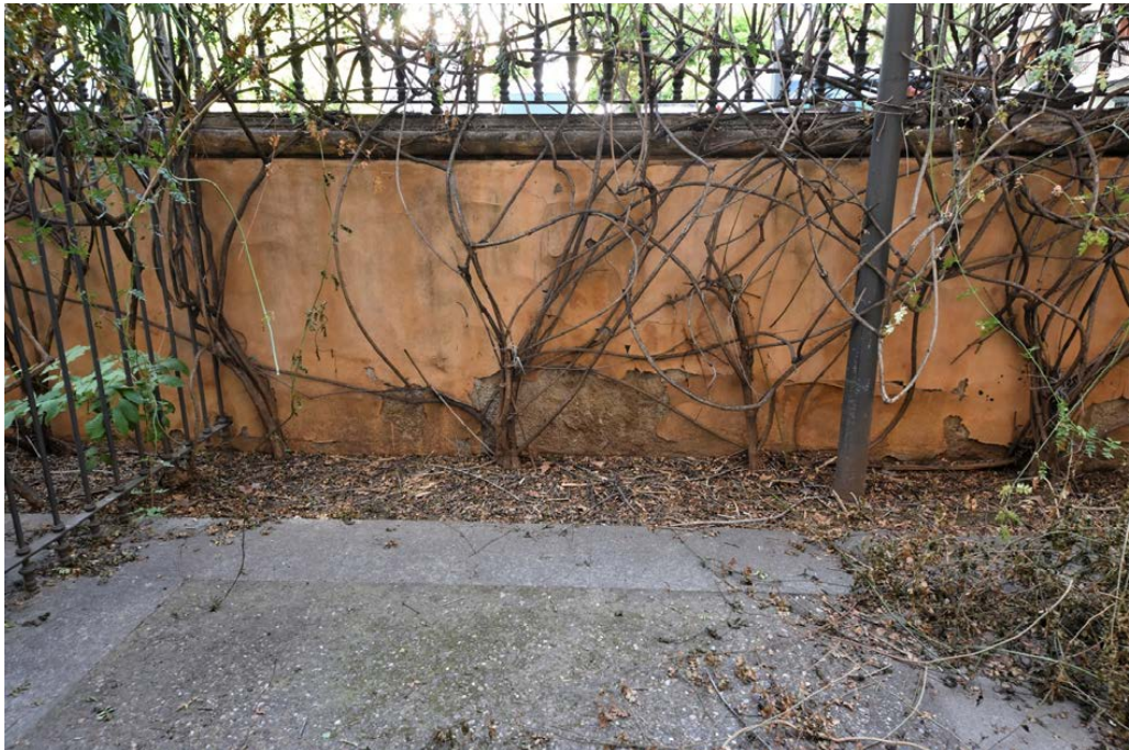
52. Cara interior del cerramiento a la plaza de la Gavidia. Se puede ver el mal estado del mortero de revestimiento, que presenta disgregaciones, fallos de adherencia, abofados y desprendimientos
