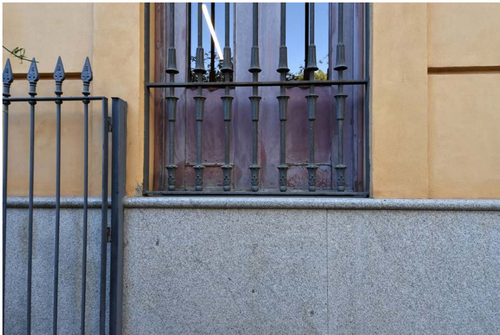
34. Detalle de una ventana en planta baja de la fachada oeste afectada por la humedad. Se puede ver la decoloración y el mal estado de la parte inferior de la ventana
