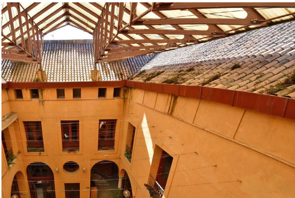
74. Zona sur del canalón del patio 2. Se puede la flecha y la deformación en el centro donde se debe acumular agua.
