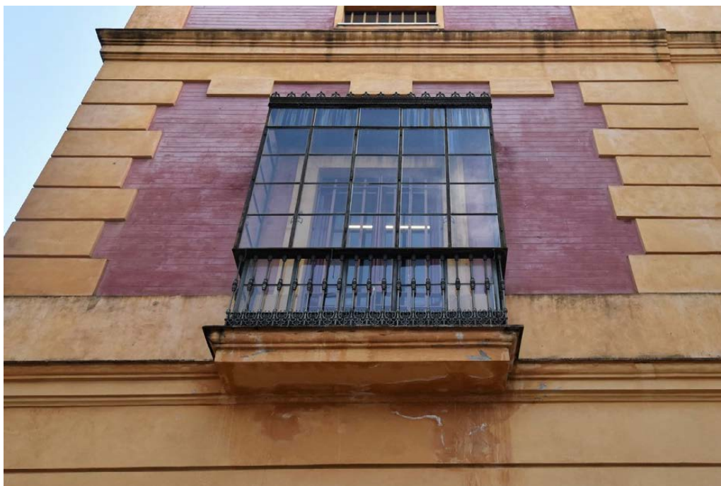
84. Cierre de planta alta de la fachada a la plaza de la Concordia. Se puede ver algunas oxidaciones y mal estado de la pintura
