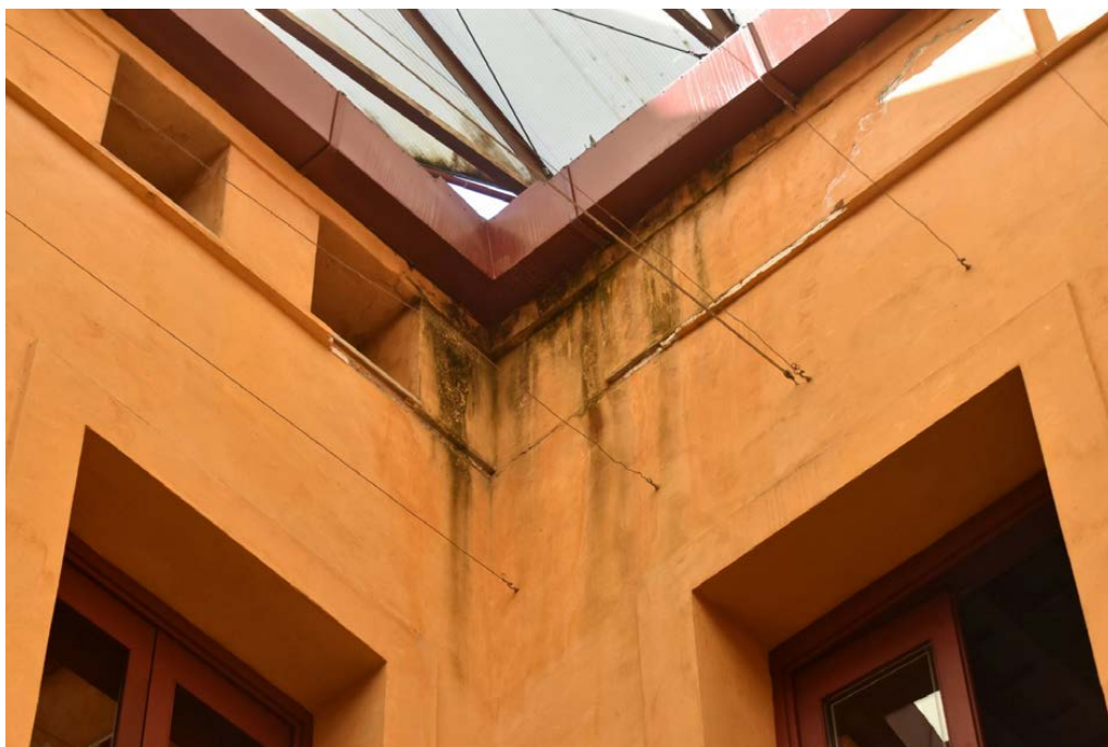
64. Fachada interior del patio 2. Se puede ver las manchas de verdín y ennegrecidos por líquenes y musgos, en la parte baja de cornisas y molduras, provocados por la escorrentía del agua de lluvia por mal estado del canalón
