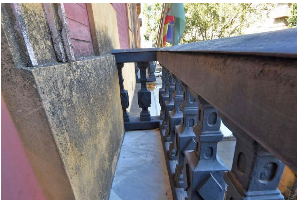
47. Solería de un balcón de planta alta de la fachada a la plaza de la Gavidia. Se puede ver la escasa separación entre la solería y la parte inferior de la barandilla y la poca pendiente, lo que dificulta la evacuación del agua de lluvia
