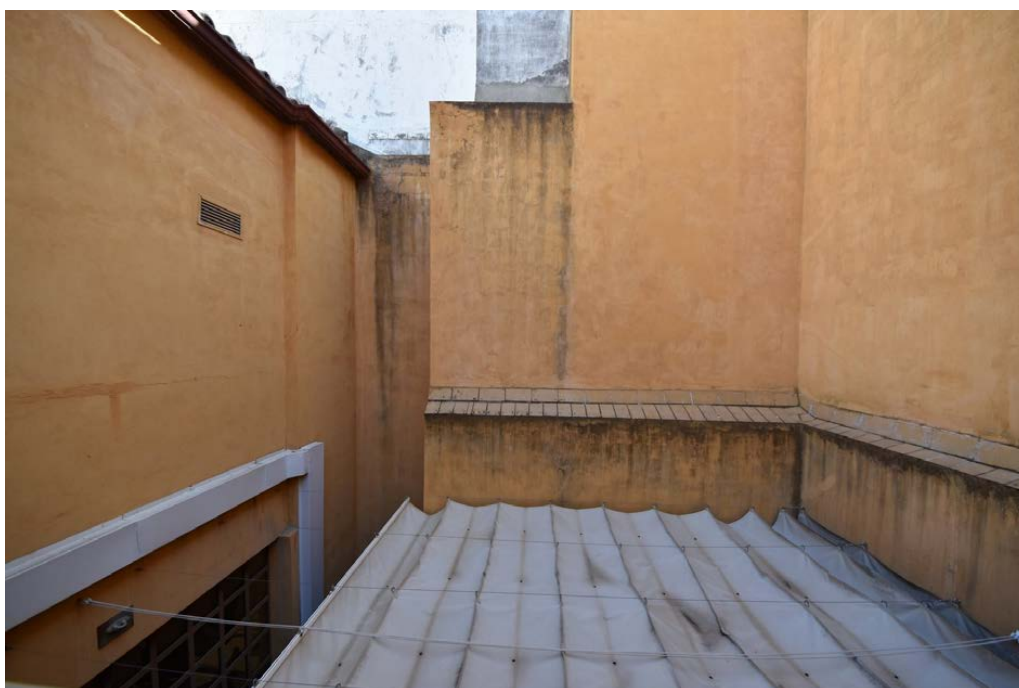
65. Fachadas interiores del patio 3. Se puede ver las manchas de verdín y ennegrecidos por líquenes y musgos, en la parte baja de cornisas y molduras, provocados por la escorrentía del agua de lluvia por falta de goterón en los remates de los muros
