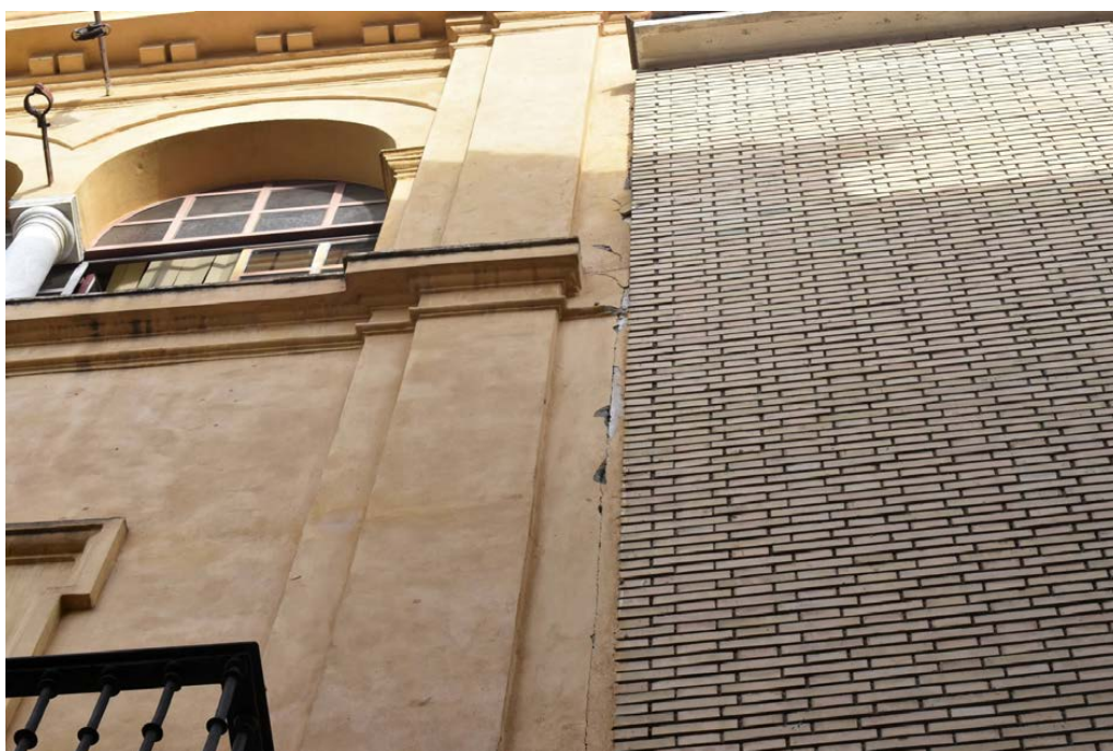
94. Fisura entre la fachada a la calle Jesús del Gran Poder y medianera del edificio colindante, por falta de junta de dilatación
