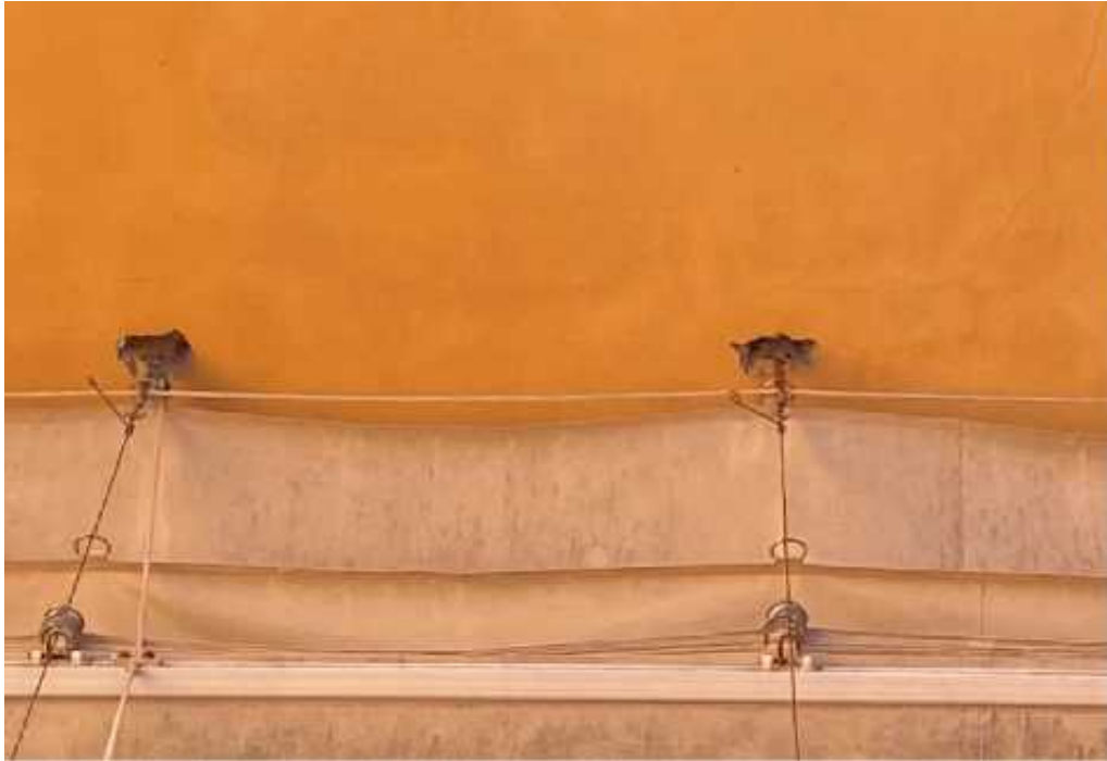
105. Detalle de los anclajes del toldo del patio 5. Se puede ver que se encuentran sin sellar lo que facilita la entrada de agua de lluvia al interior del muro
