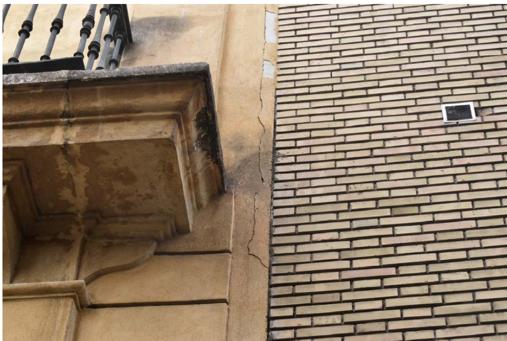
95. Detalle de la fisura entre la fachada a la calle Jesús del Gran Poder y medianera del edificio colindante, por falta de junta de dilatación
