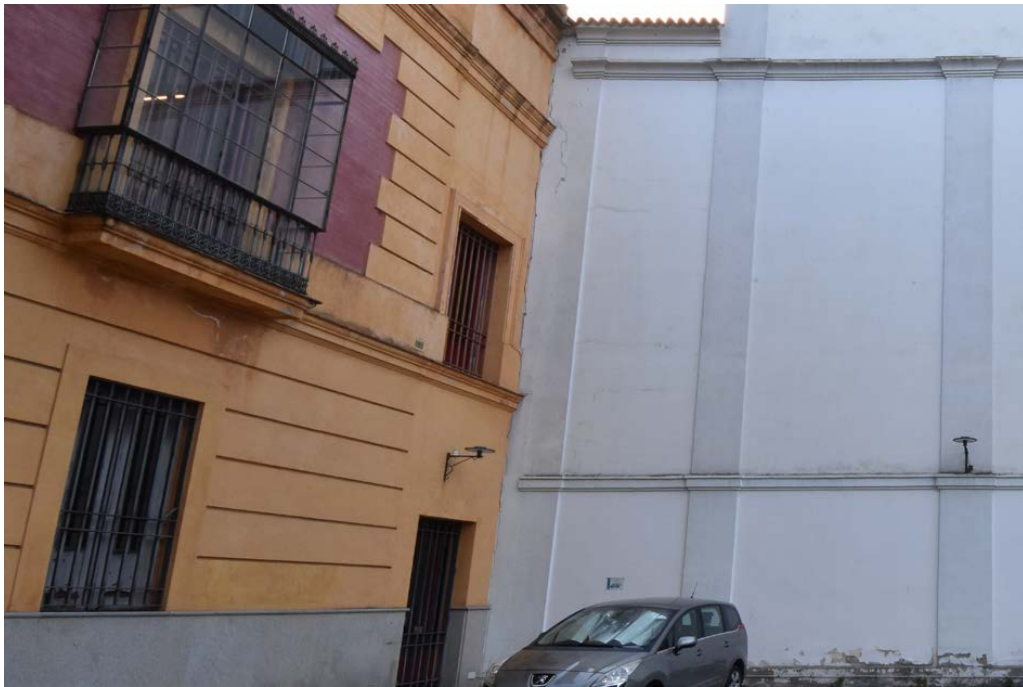
90. Fisura entre la fachada a la plaza de la Concordia y medianera del edificio colindante, por falta de junta de dilatación
