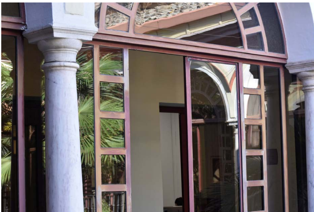
88. Detalle de carpintería metálica de la planta alta del patio principal. Se puede observar deterioro en la pintura y oxidación superficial
