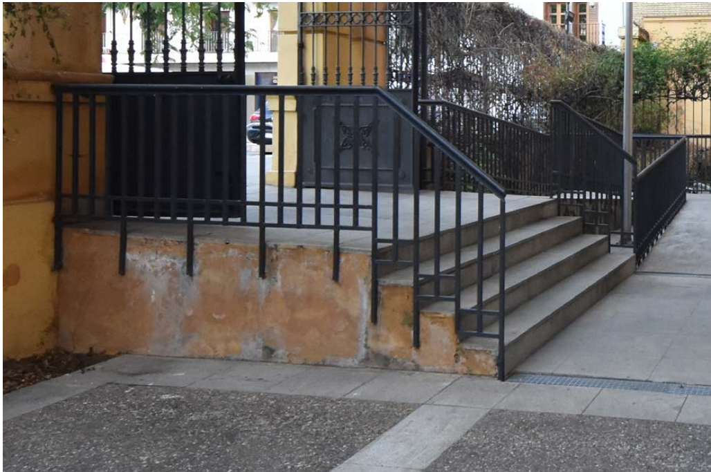
56. Lateral de la escalera de acceso desde la plaza de la Gavidia. Se puede ver el mal estado del mortero de revestimiento, que presenta manchas de sales y disgregaciones.
