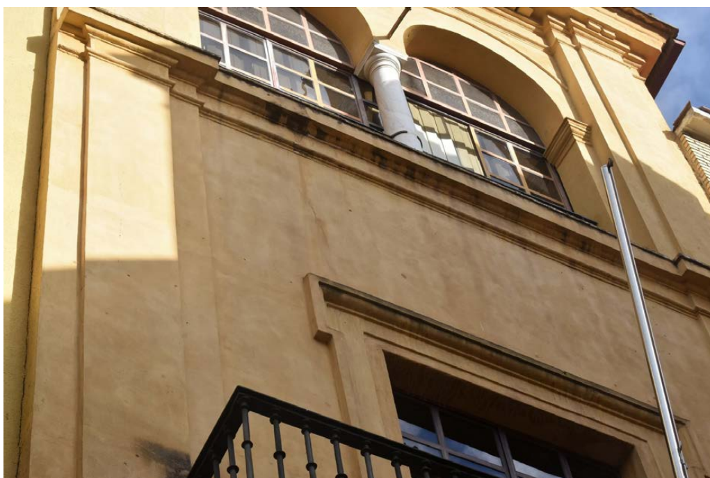
96. Fisura en la fachada a la calle Jesús del Gran Poder sobre el balcón de planta primera
