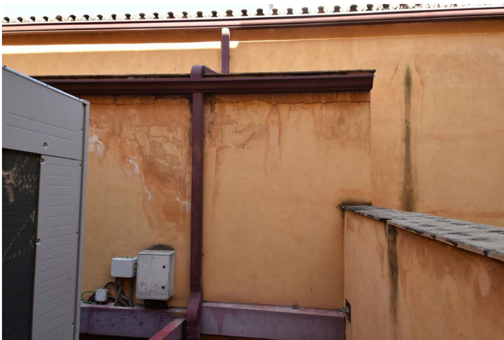
76. Canalón de la fachada oeste patio 3. Se puede las manchas de humedad y las fisuras en el revestimiento originadas por el mal funcionamiento del canalón
