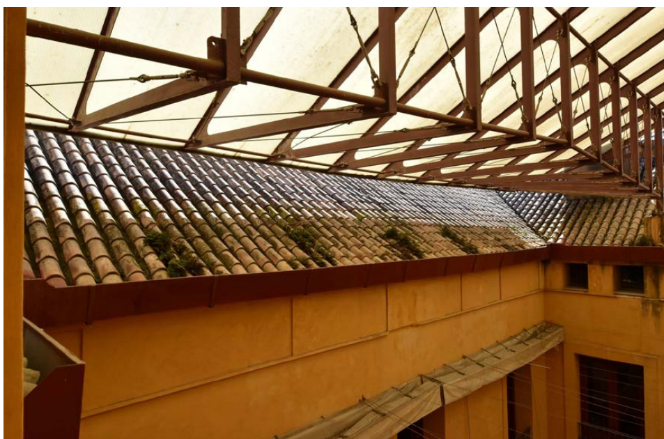
73. Zona norte del canalón del patio 2. Se puede la flecha y la deformación en el centro donde se debe acumular agua.
