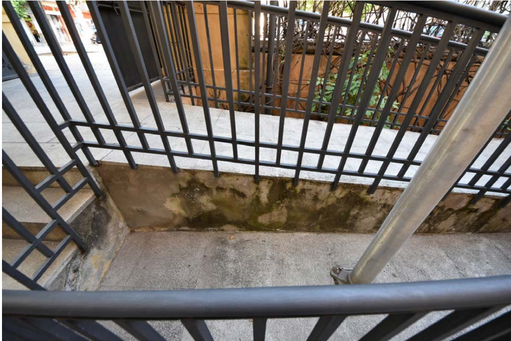
57. Lateral de la rampa en la entrada desde la plaza de la Gavidia. Se puede ver el mal estado del mortero de revestimiento, que presenta manchas de verdín, disgregaciones, abofados y desprendimientos
