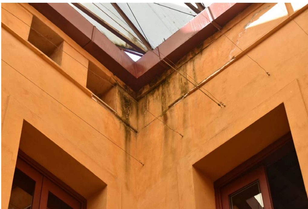
44. Detalle de moldura en el patio 2, con pérdida de piezas en las zonas donde existen humedades por el mal estado del canalón
