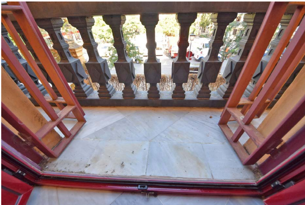
46. Solería de un balcón de planta alta de la fachada a la plaza de la Gavidia. Se puede ver la escasa separación entre la solería y la parte inferior de la barandilla, lo que dificulta la evacuación del agua de lluvia
