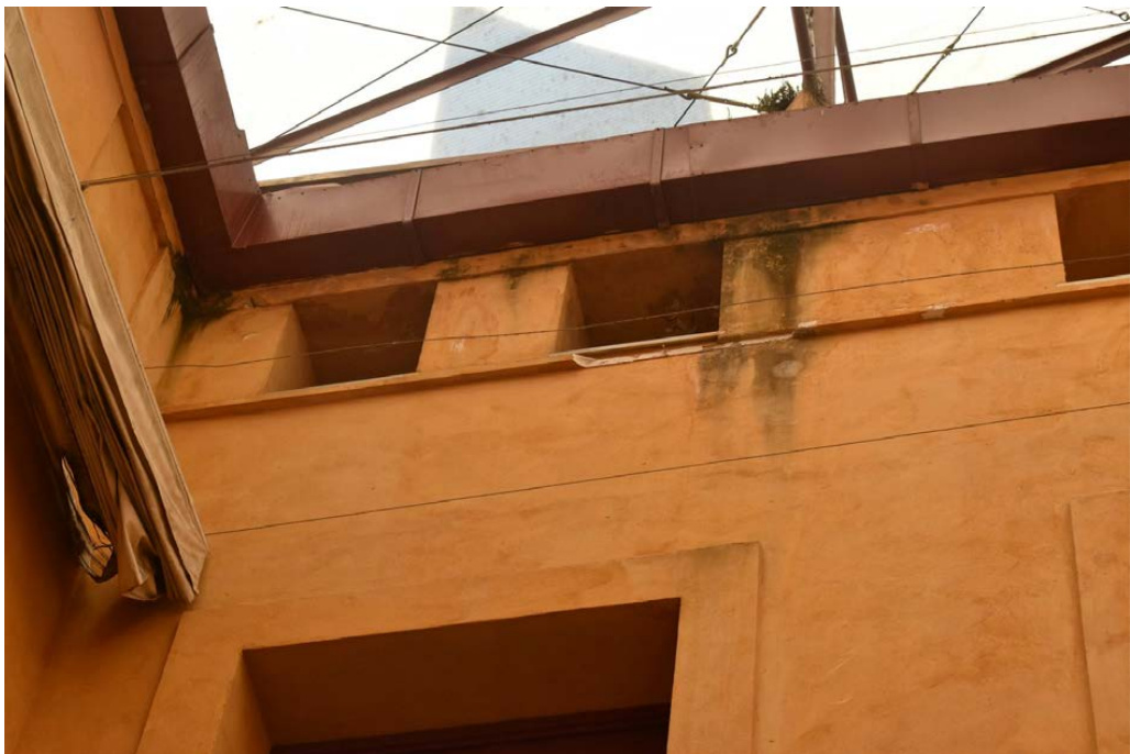
63. Fachada interior del patio 2. Se puede ver las manchas de verdín y ennegrecidos por líquenes y musgos, en la parte baja de cornisas y molduras, provocados por la escorrentía del agua de lluvia por mal estado del canalón
