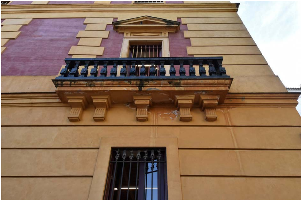
51. Balcón de planta alta de la fachada a la plaza de la Gavidía. Se puede ver las manchas de humedad, sales y verdín provocados por la entrada de agua de lluvia
