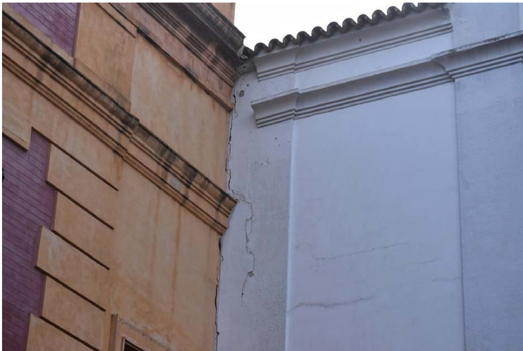
91. Detalle de la fisura entre la fachada a la plaza de la Concordia y medianera del edificio colindante, por falta de junta de dilatación
