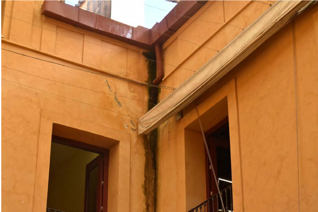
62. Fachada interior del patio 2. Se puede ver las manchas de verdín y ennegrecidos por líquenes y musgos, en la parte baja de cornisas y molduras, provocados por la escorrentía del agua de lluvia por mal estado del canalón
