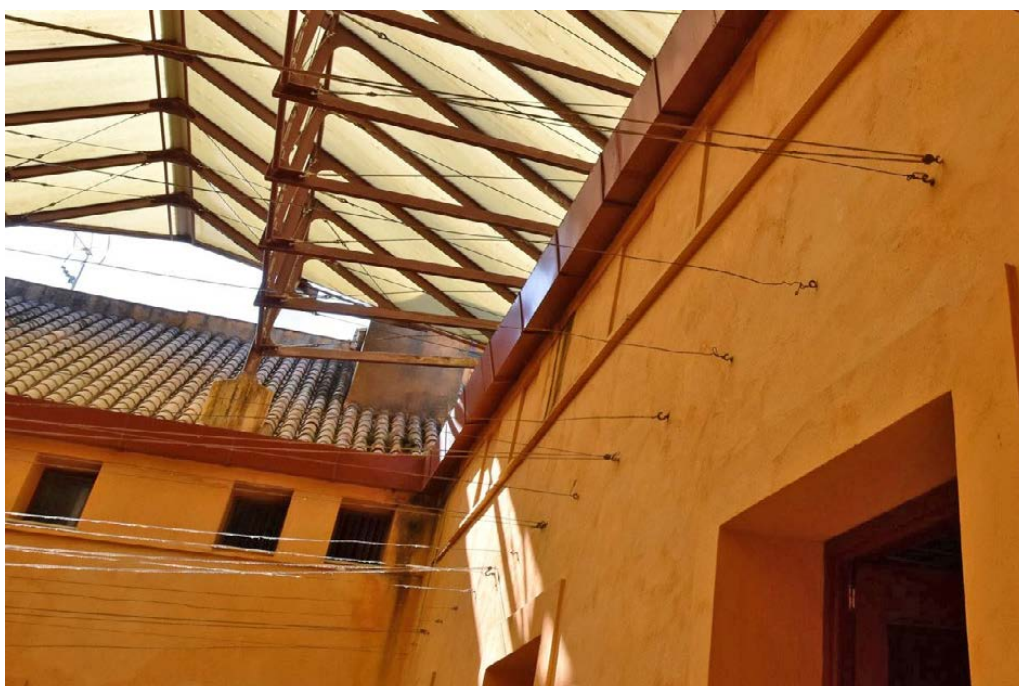
103. Detalle de la montera del patio 2. Se puede ver el mal estado de la pintura y las placas de policarbonato
