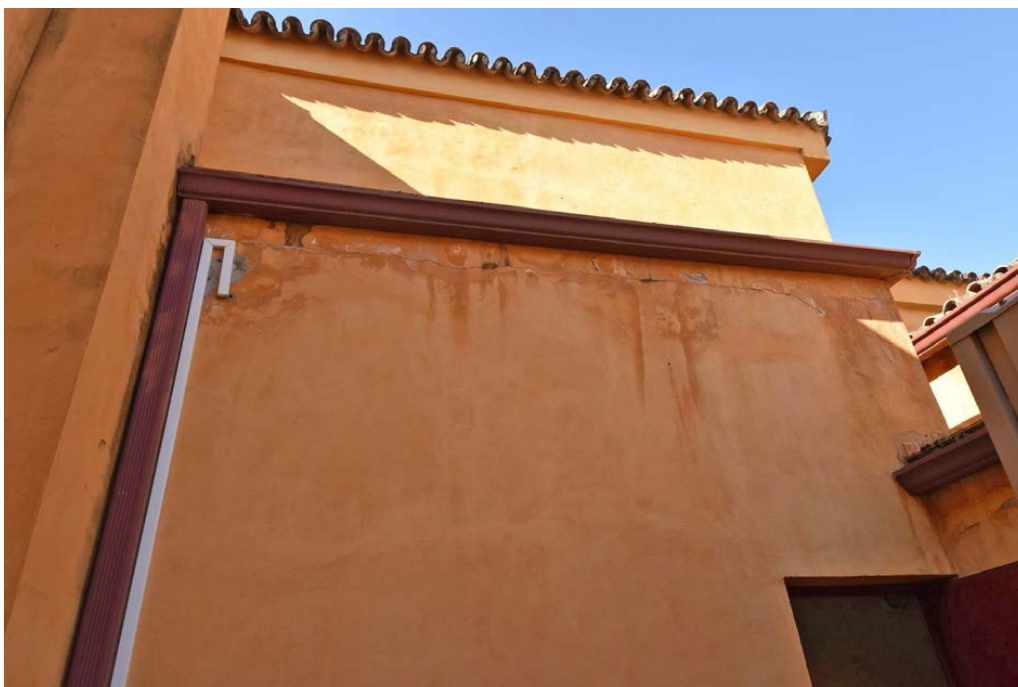
78. Canalón de la fachada sur del patio 3. Se puede las manchas de humedad y las fisuras en el revestimiento originadas por el mal funcionamiento del canalón
