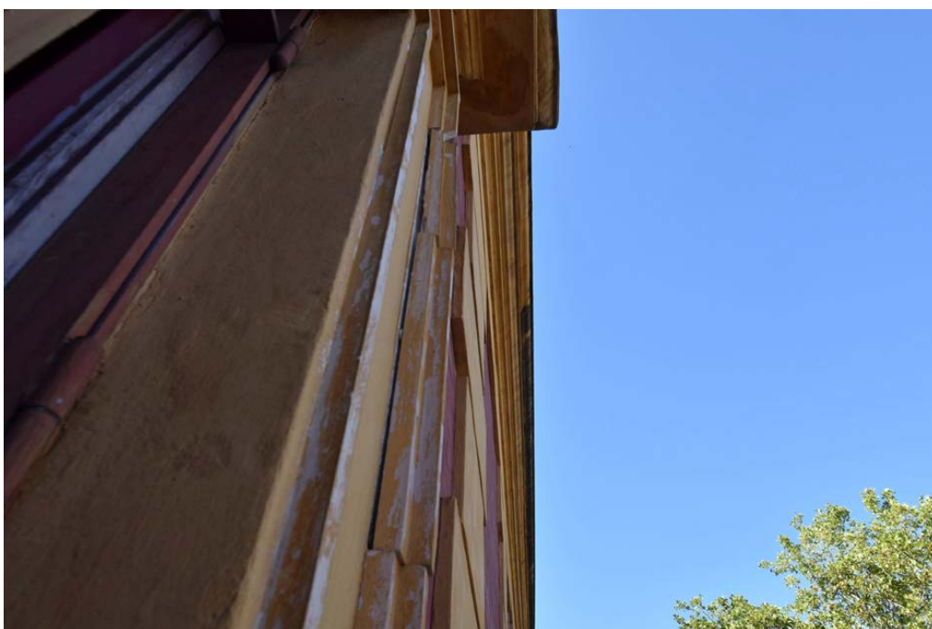
41. Detalle de una ventana en planta alta de la fachada oeste. Se puede las piezas de la moldura a punto de desprenderse
