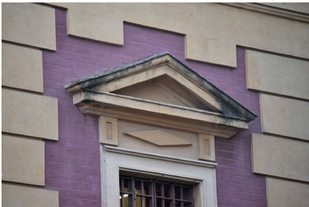
60. Fachada a la plaza de la Gavidía. Se puede ver las manchas de verdín y ennegrecidos por líquenes y musgos, en la parte baja de las molduras, provocados por la escorrentía del agua de lluvia por falta de goterón
