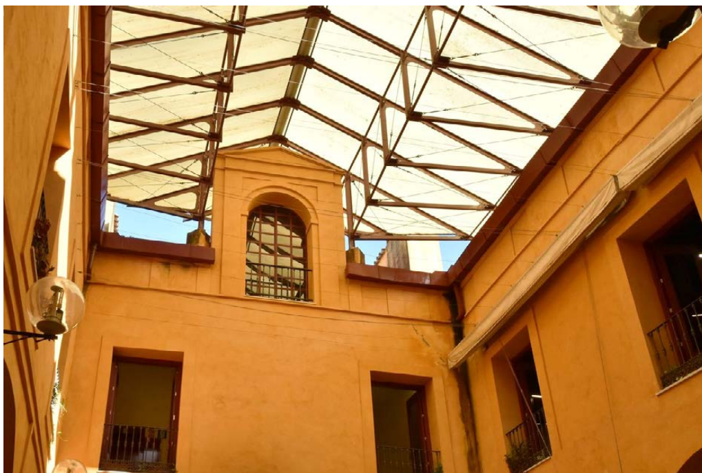
102. Montera del patio 2. Se puede ver el mal estado de la pintura y las placas de policarbonato
