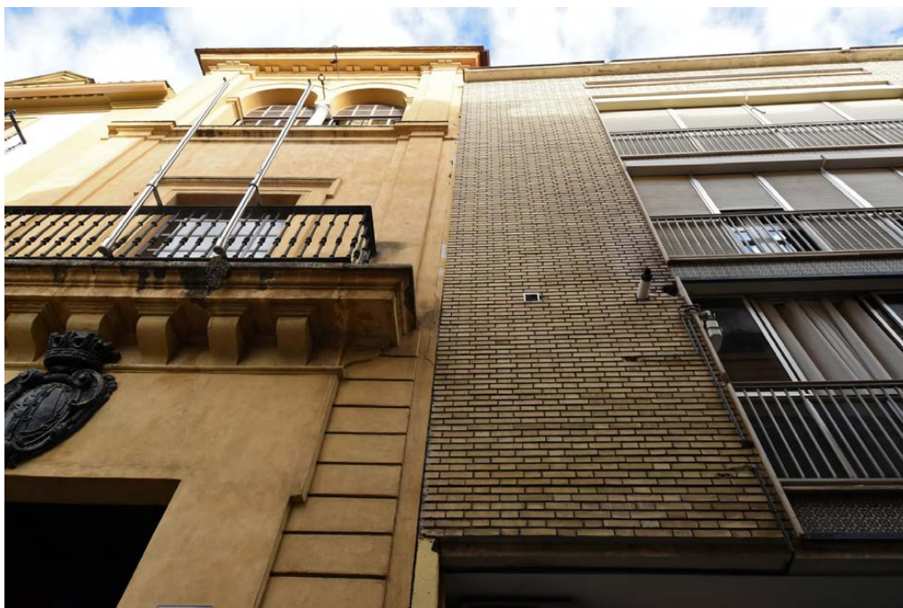
93. Fisura entre la fachada a la calle Jesús del Gran Poder y medianera del edificio colindante, por falta de junta de dilatación
