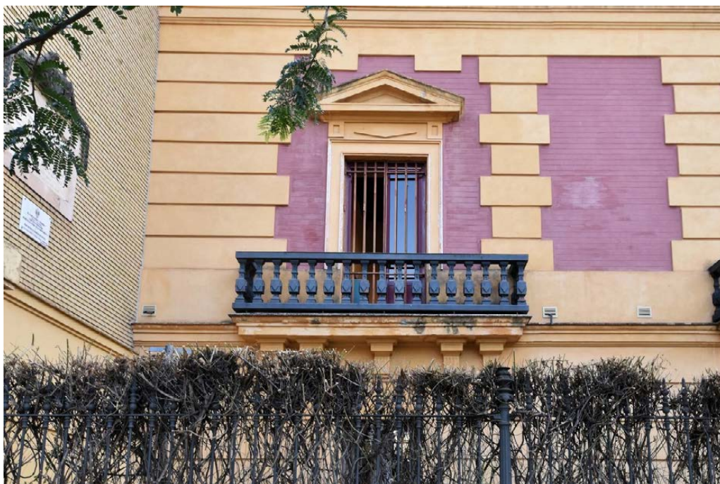
48. Balcón de planta alta de la fachada a la plaza de la Gavidía. Se puede ver las manchas de humedad y verdín provocados por la entrada de agua de lluvia
