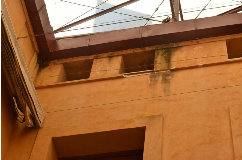
45. Detalle de moldura en el patio 2, con pérdida de piezas en las zonas donde existen humedades por el mal estado del canalón
