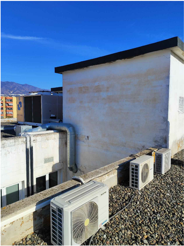
3.- A.2 Actuaciones sobre las instalaciones térmicas: Unidades exteriores de Splits
