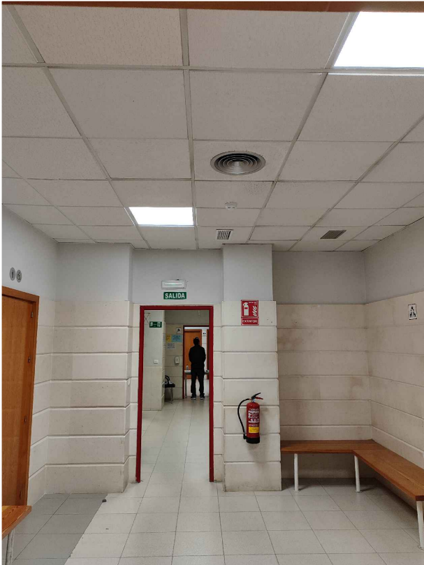
1.- A.3 Actuaciones sobre otras instalaciones: Luminarias zonas comunes
