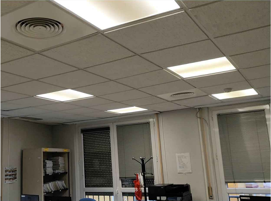
4.- A.3 Actuaciones sobre otras instalaciones: Luminaria en espacios de trabajo
