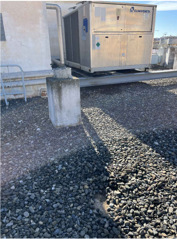
2.- A.2 Actuaciones sobre las instalaciones térmicas: Enfriadora existente
