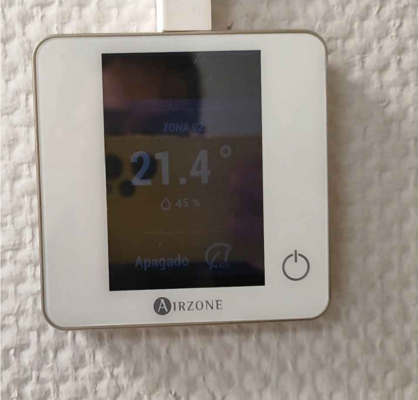
3.- A.2 Actuaciones sobre las instalaciones térmicas: Climatización de espacios de trabajo con sistema "Airzone"
