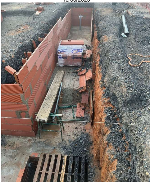
Nuevamente fosos con daños e inundados
