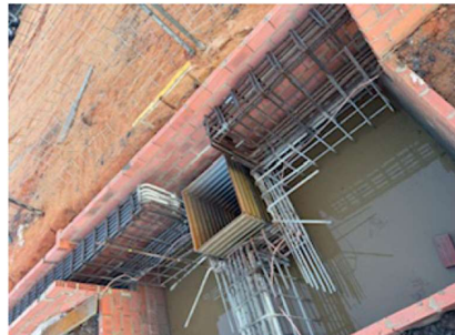
Cimentaciones inundadas por las lluvias
