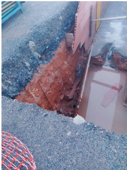
Vuelve a producirse daños en el foso e inundación
