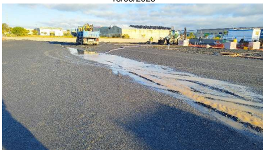
Obra enfangada e intransitable
