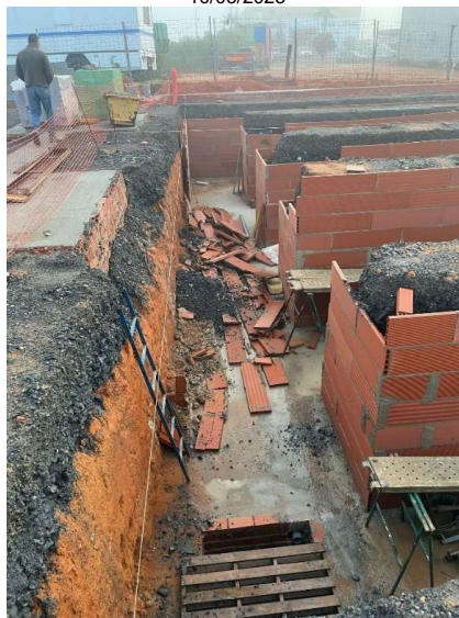
Nuevamente fosos con daños e inundados
