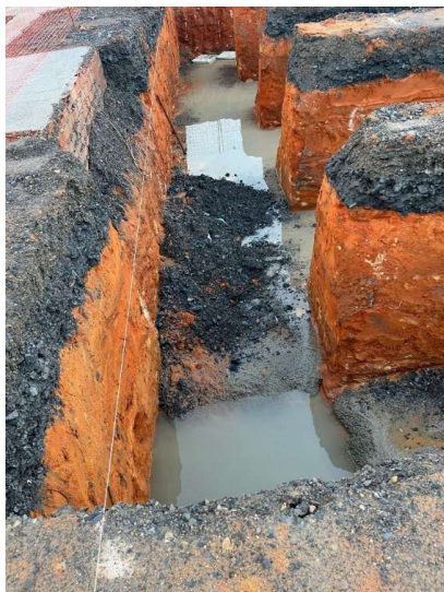
Fosos con daños e inundados
