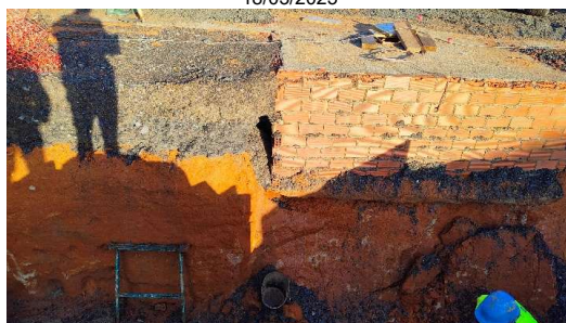
Desprendimiento de tierras en cimentaciones
