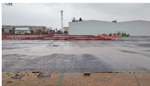
Lluvias intensas que provocan daños en los trabajos
