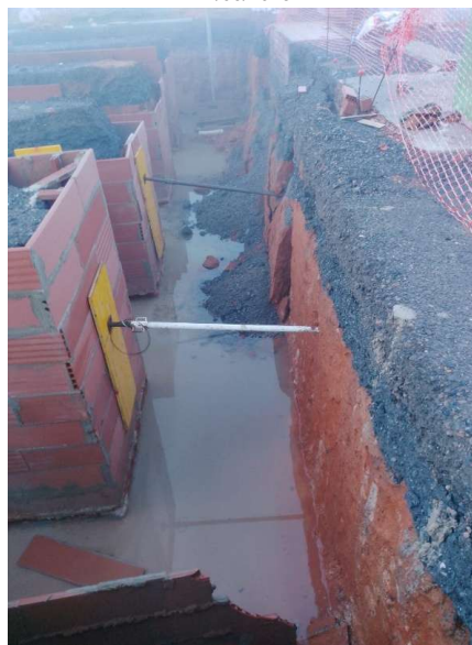
Desprendimientos del terreno bajo cimentación
