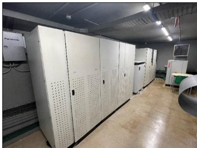
Foto 1. SAI en el Edificio Expo
