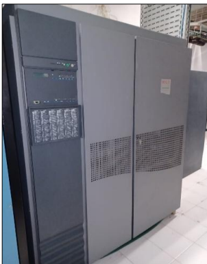
Foto 2. SAIS en el Edificio S3
