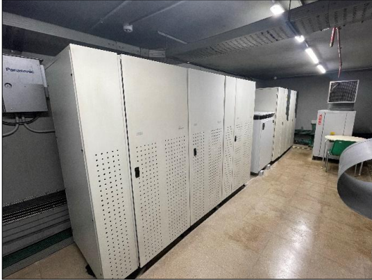
Foto 1. SAIS en el Edificio Expo
