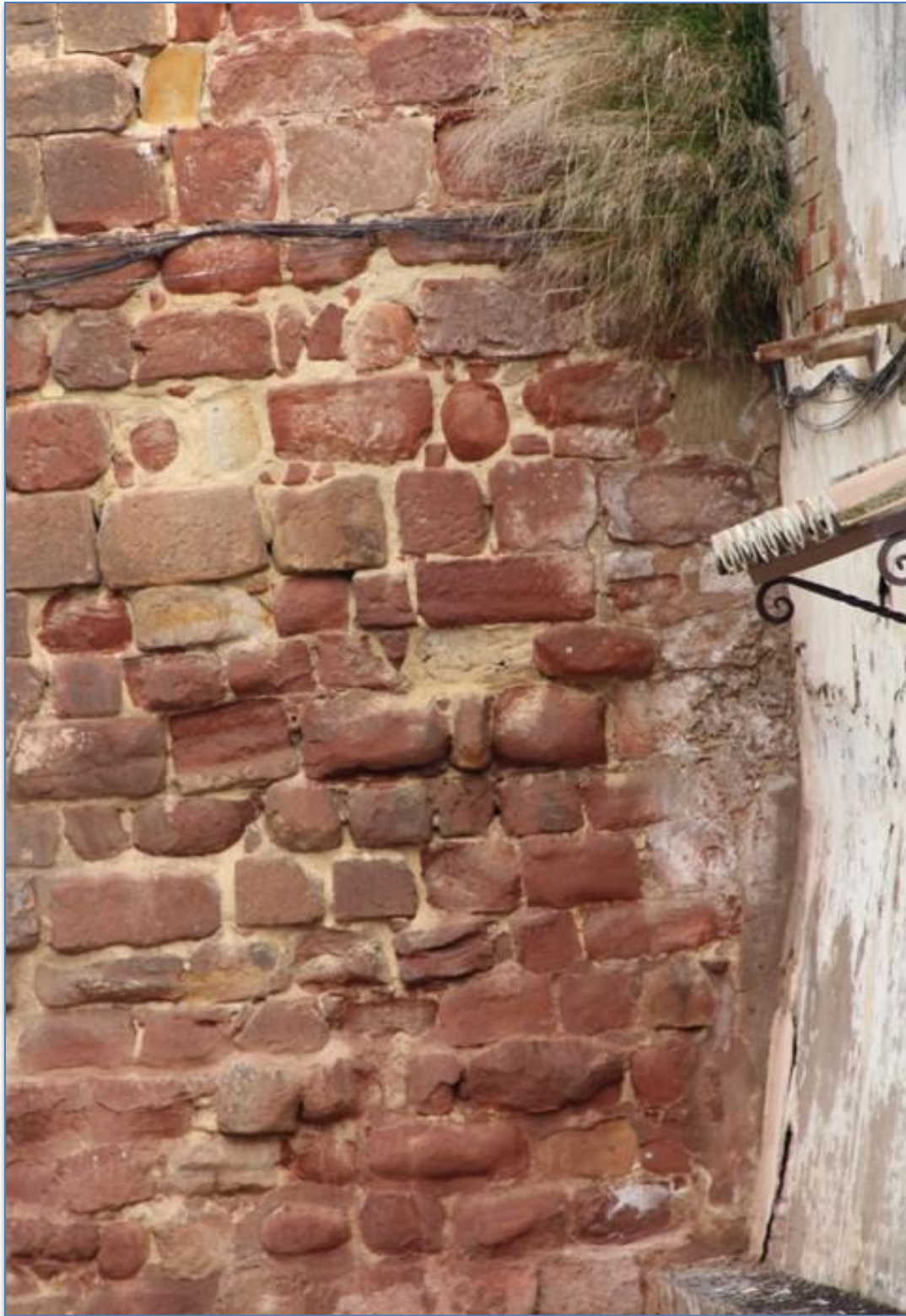
Detalle patologías humedades alzado sur
