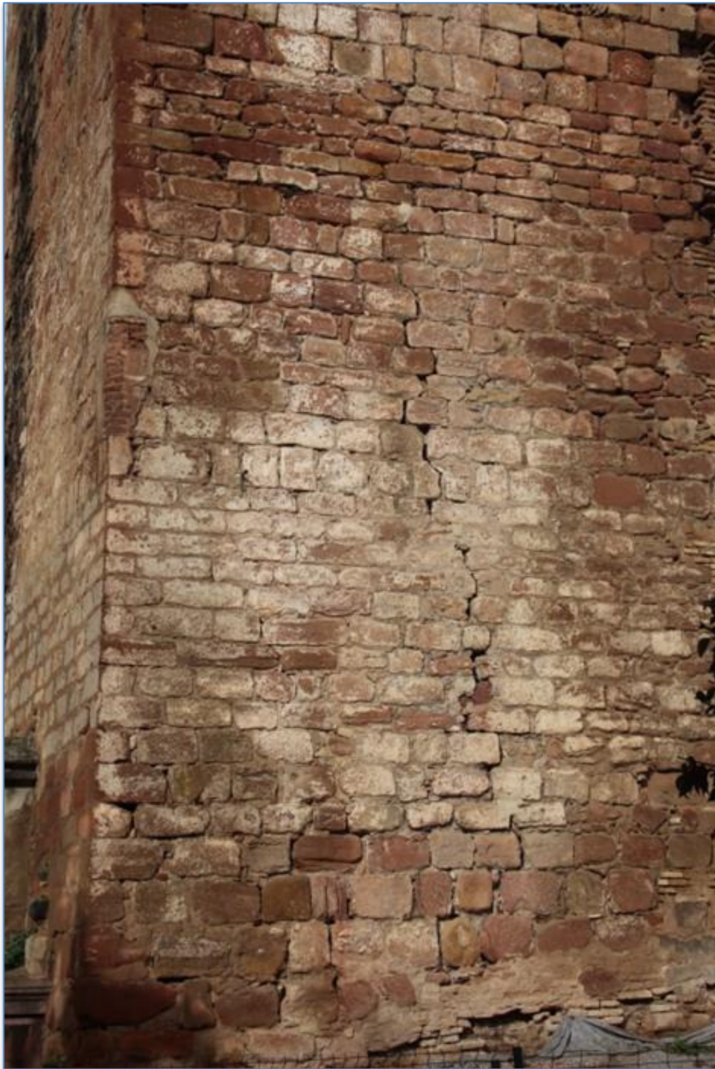
Detalle grieta alzado este
