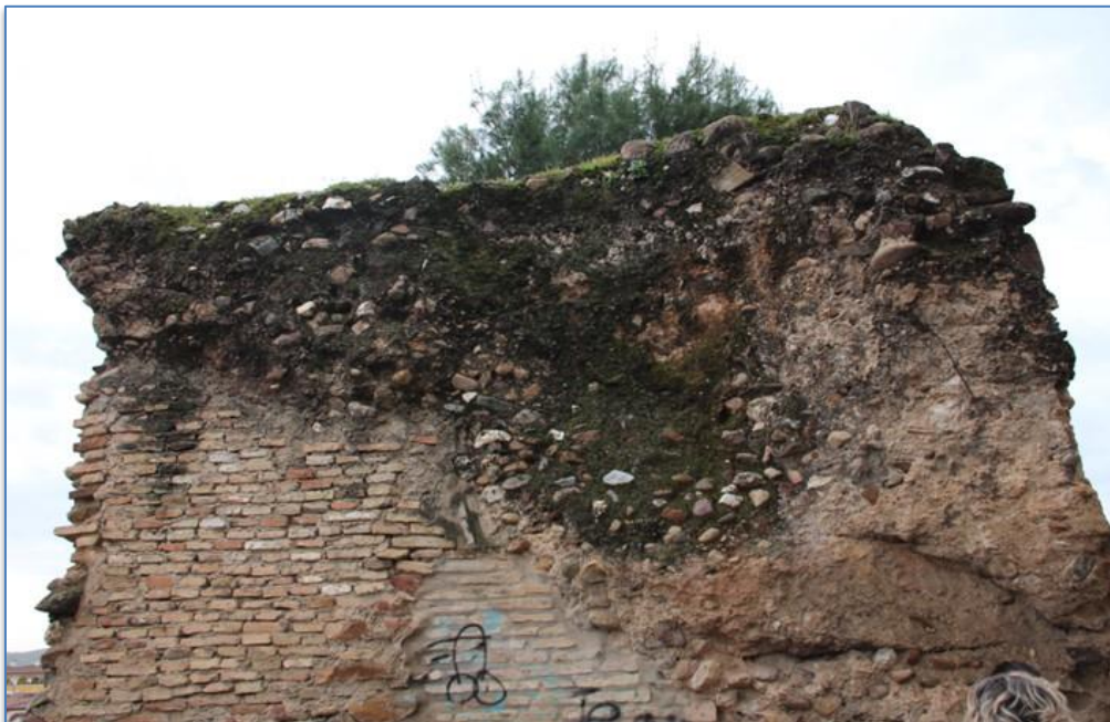
Detalle patologías organismos biológicos
