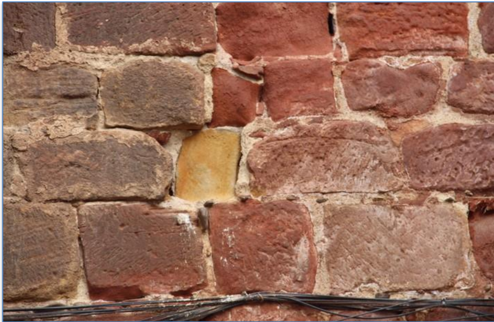
Detalle patologías en alzado oeste
