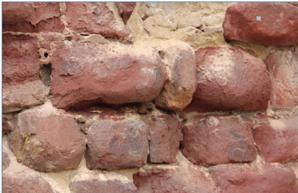
Detalle patologías en alzado sur
