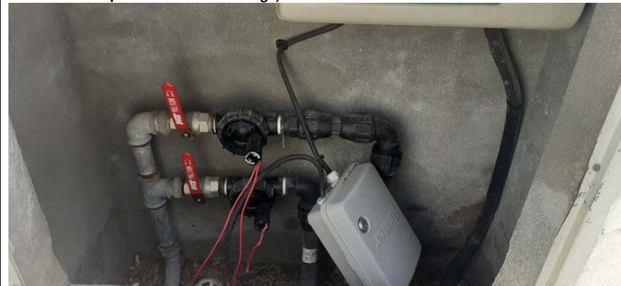
Foto 12 Detalle interior de armario de riego.
