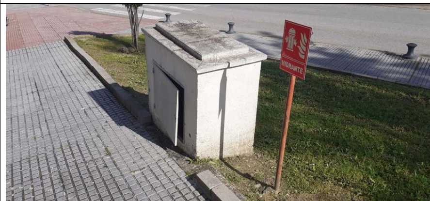
Foto 11 Armario para instalaciones de riego, extremo NO.
