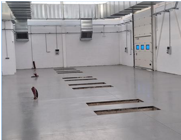
Fotografía de los fosos en una de las naves del centro educativo
