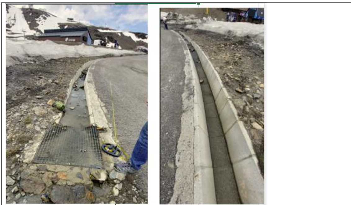
Estado actual de la cuneta. Tramo a reparar : Aprox 10m.
