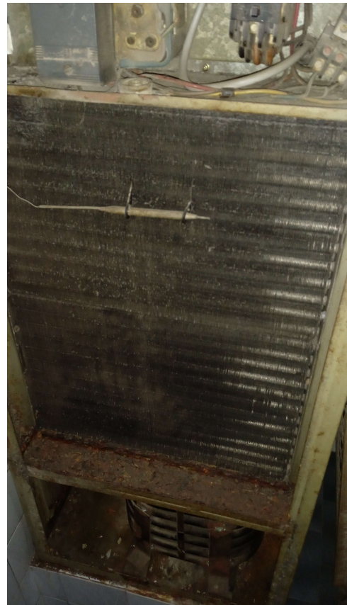
Máquina aire acondicionado (A2)
