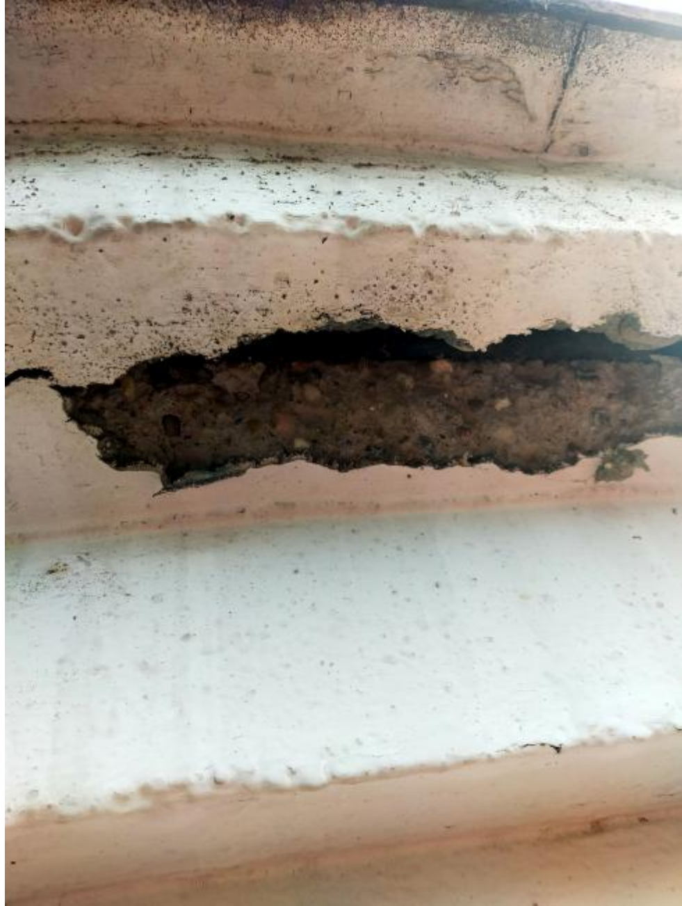
Losa de hormigón de apoyo de la linterna con daños provocados por filtraciones que afectan a armaduras.
