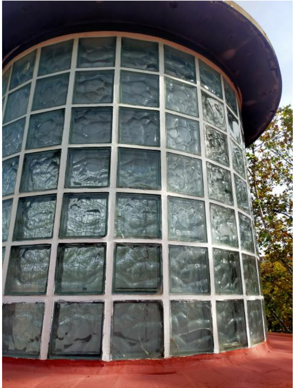
Area de piezas dañadas
