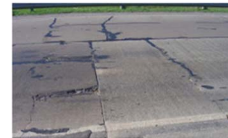
Tipos de fisura según la orientación
