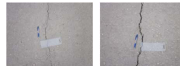
Tipo de fisura según abertura
