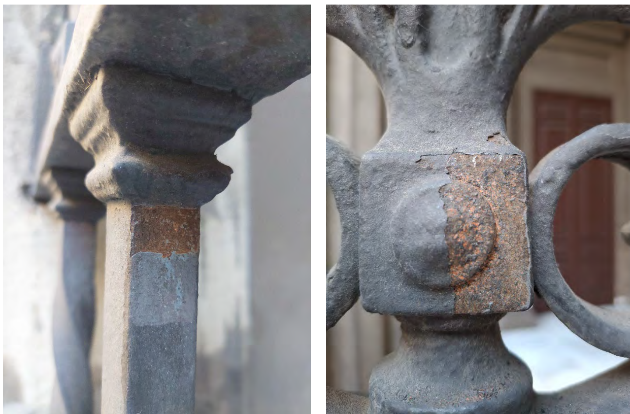
A la izquierda detalle de C2 con la capa gris azulada debajo de la actual y el soporte en la zona superior. A la derecha C4 con capa de minio sobre el soporte
