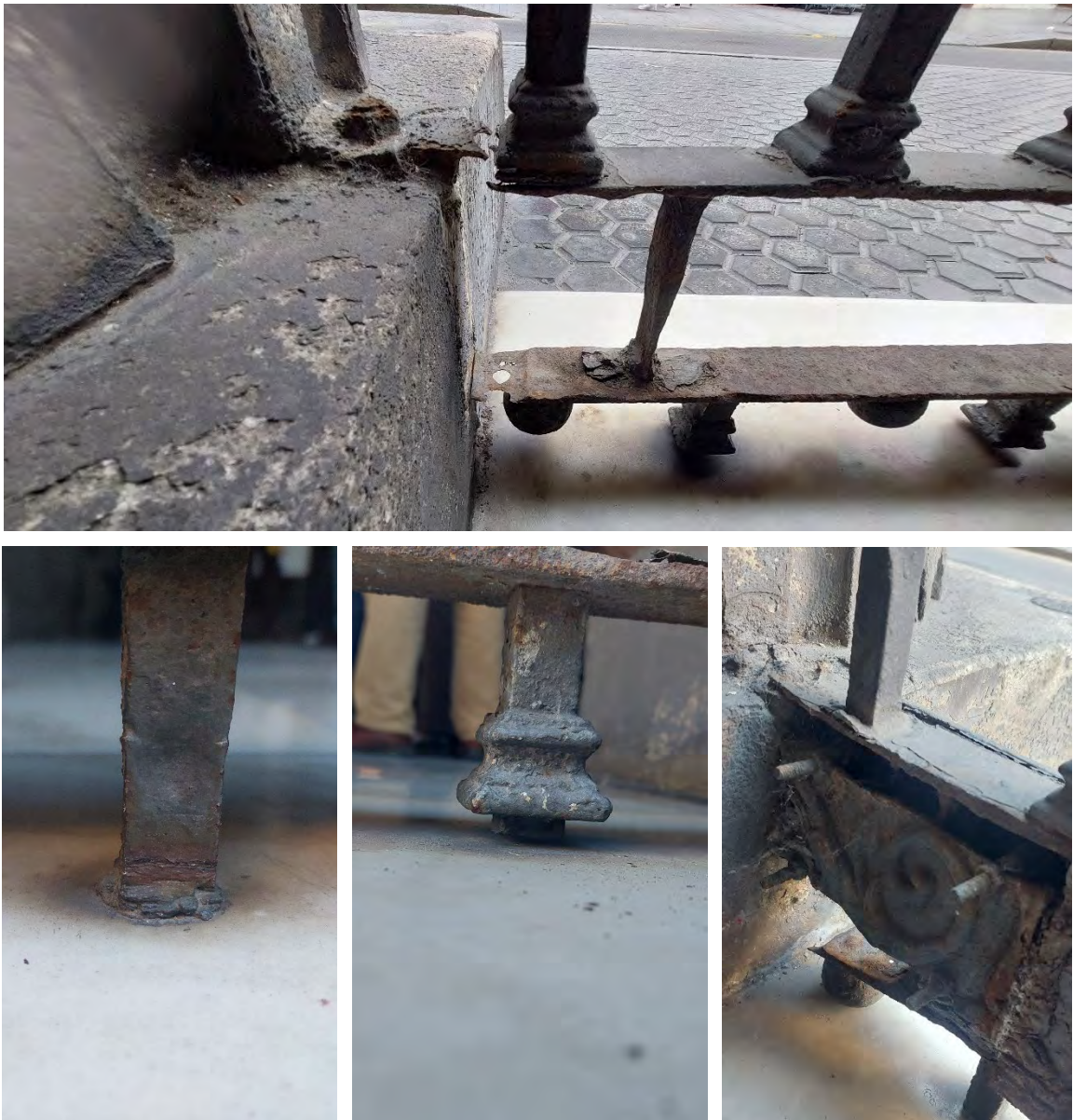
En la imagen superior desplazamiento de la zona inferior del tramo izquierdo. Debajo en la imagen izquierda y central apoyos añadidos entre barrotes y el suelo. A la derecha desplazamiento del travesaño inferior en el tramo derecho.
