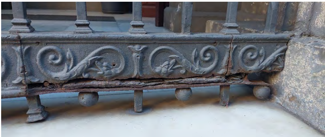
Proceso avanzado de corrosión en el zócalo inferior del tramo derecho
