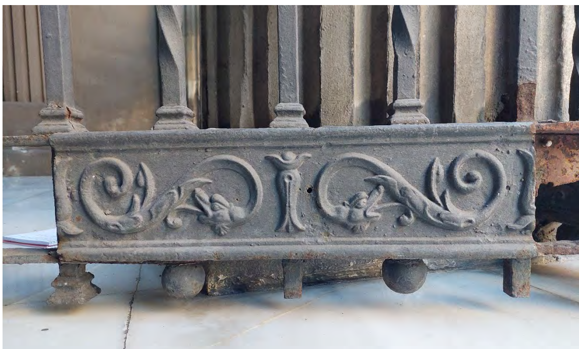
Detalle de placa perdida en el tramo izquierdo en la fotografía superior. En la fotografía inferior detalle de la cancela derecha donde se aprecia pérdida de placas, de macollas y de pasadores de sujeción de la placa.
