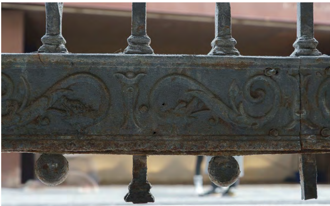
En la imagen superior C3, observar que bajo la actual capa solo está el soporte. Abajo, zona inferior con oxidación, depósitos de suciedad y pérdida de capa de protección
