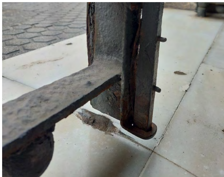
En la imagen superior, fragmentación de la piedra del fuste provocada por los anclajes de la verja. Debajo, erosiones del pasador en la solería de mármol
