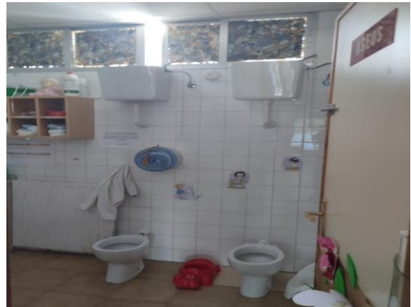
Vista de inodoros inadecuados
