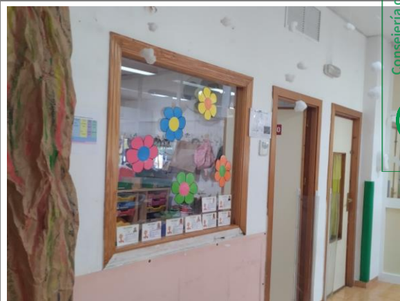
Desprendimiento de marco de carpintería
