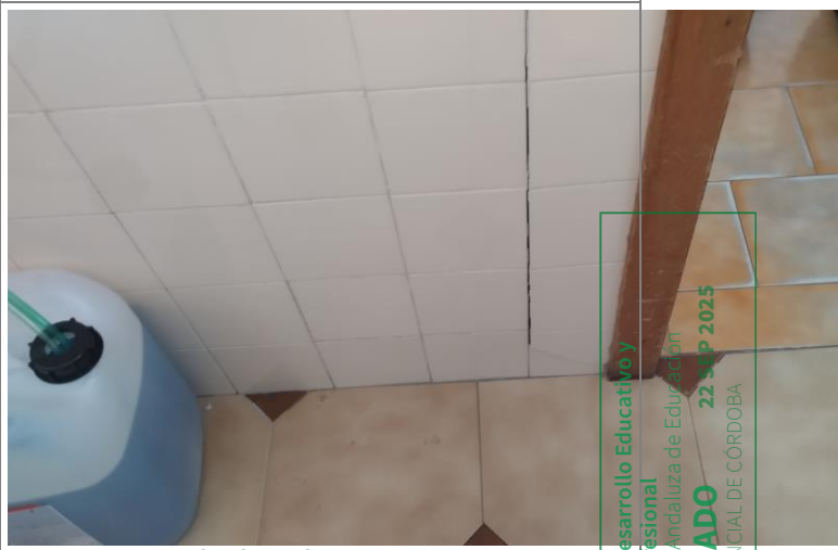
Falta de media caña sanitaria
