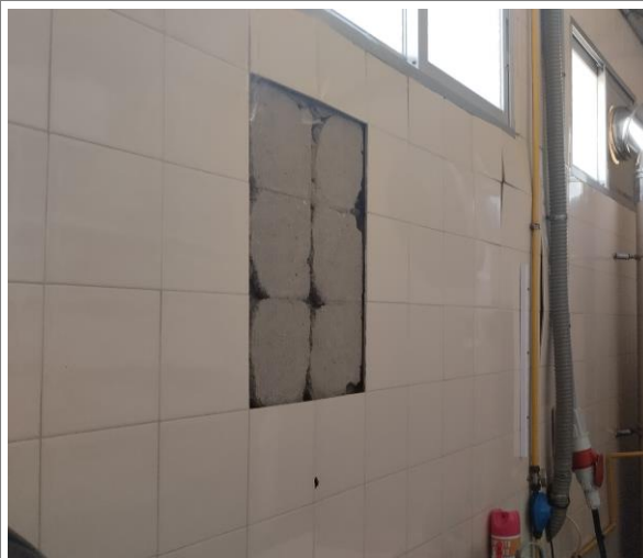
Desprendimiento de alicatado en lavandería
