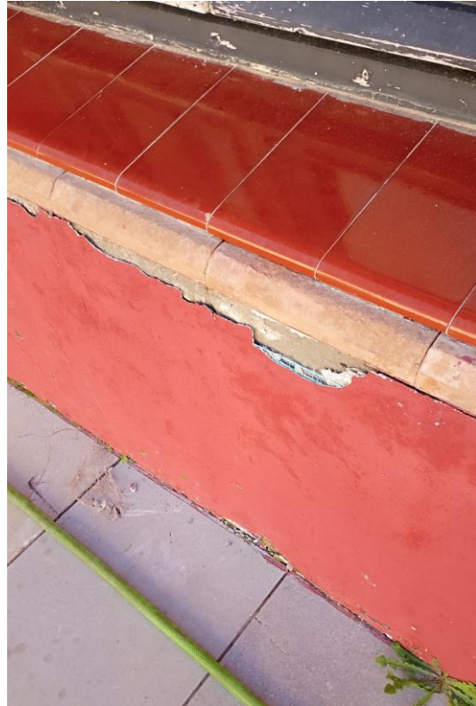
Detalle de la fachada norte. Desprendimiento de revestimientos y pinturas
