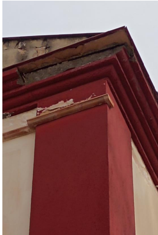
Estado de la cornisa en el ángulo suroeste. Desprendimientos de fragmentos de hormigón y corrosión de las armaduras.
