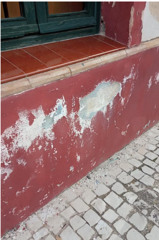
Detalle de la fachada norte. Sales y desprendimientos de revestimientos.
