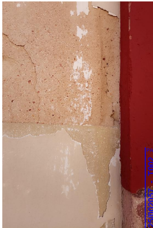
Detalle de la fachada norte. Desprendimientos de revestimientos v pintura. Junta de morteros diferentes.
