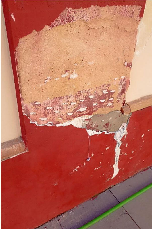
Detalle de la fachada norte. Desprendimientos de revestimientos v pintura.
