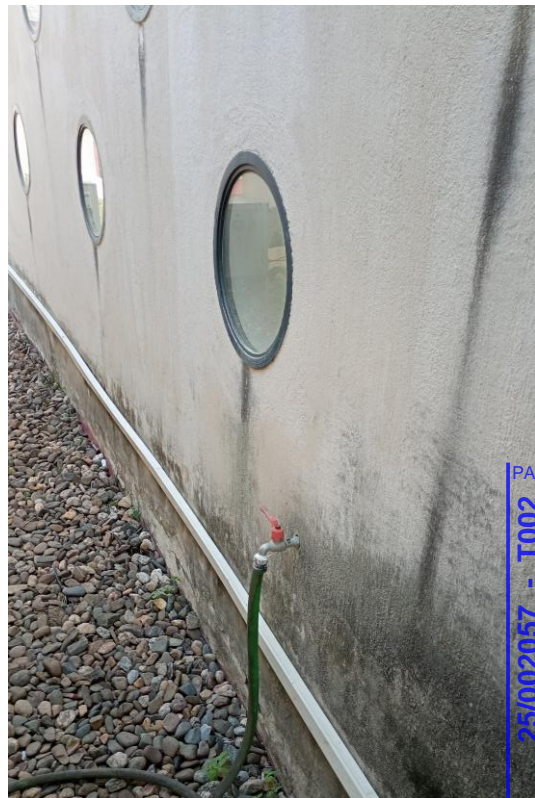
Detalle de la fachada sur. Zonas con humedades de escorrentía.
