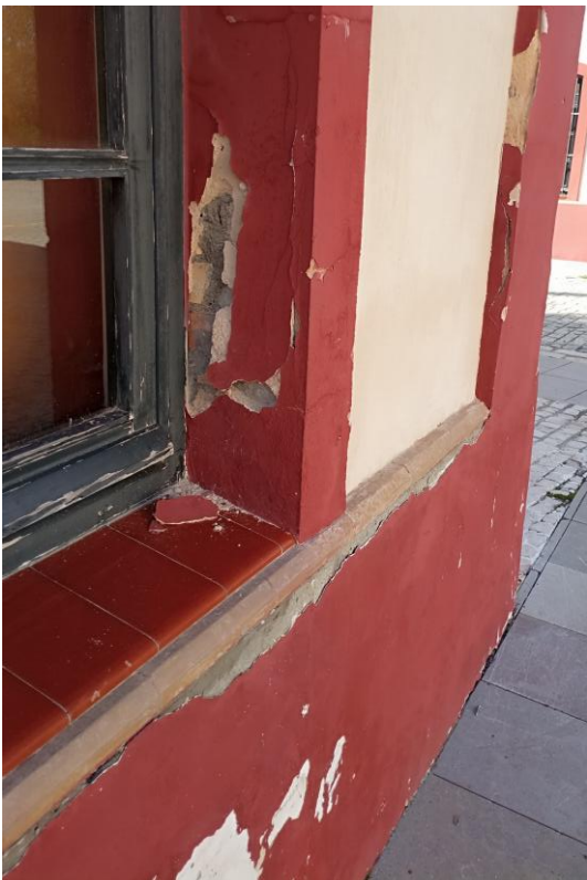
Detalle de la fachada norte. Desprendimiento de revestimientos v pintura
