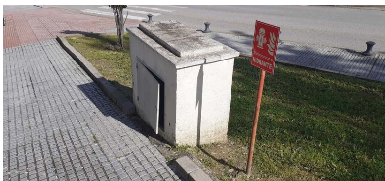
Foto 11 Armario para instalaciones de riego, extremo NO.
