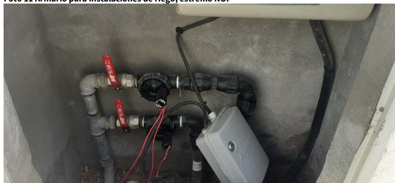
Foto 12 Detalle interior de armario de riego.
