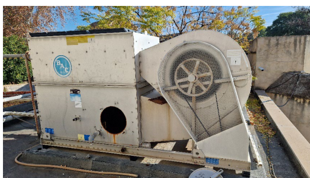
Fig. 3.3.C. Torre de refrigeración obsoleta.
