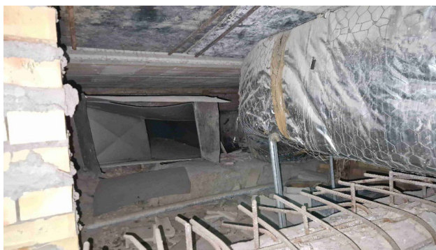
Fig. 6.3.A. Red de conductos y toma de aire del Climatizador CLI-08 del Centro de Documentación de Estudios.
