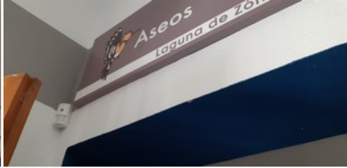
Fotografía n.º 23. Detector de presencia
