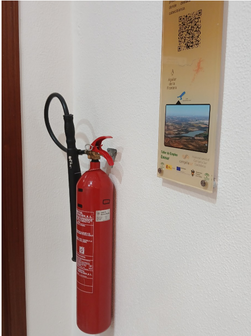
Fotografía n.º 19. Extintor
