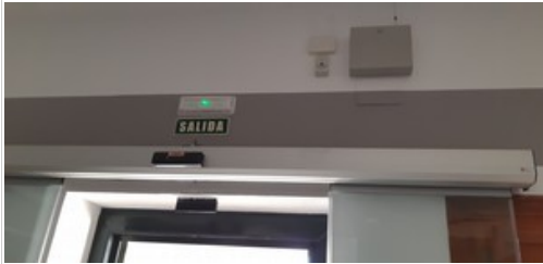
Fotografía n.º 24. Luminaria de emergencia
