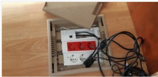
Fotografía n.º 46. Caja conexiones VGA
