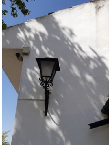
Fotografía n.º 74. Farola con soporte de pared
