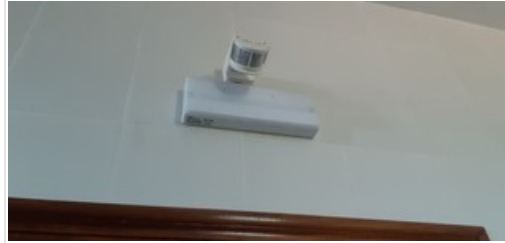
Fotografía n.º 37. Detector de presencia
