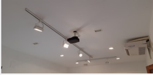
Fotografía n.º 48. Carriles electrificados para focos halógenos y seis focos halógenos
