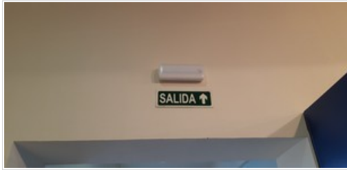
Fotografía n.º 53. Luminaria de emergencia
