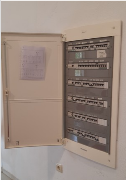
Fotografía n.º 44. Caja cuadro eléctrico
