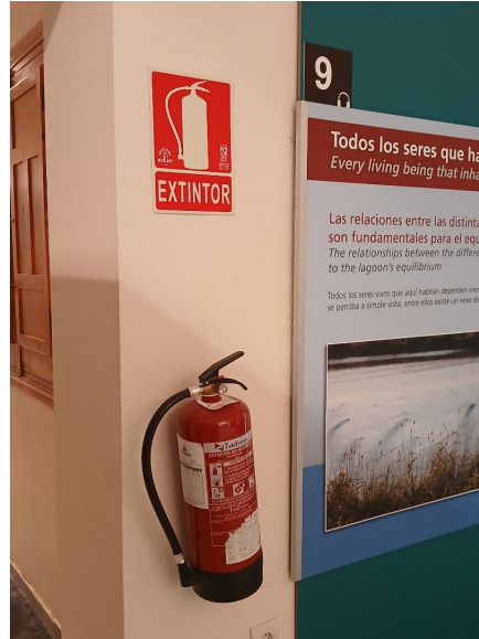
Fotografía n.º 18. Extintor
