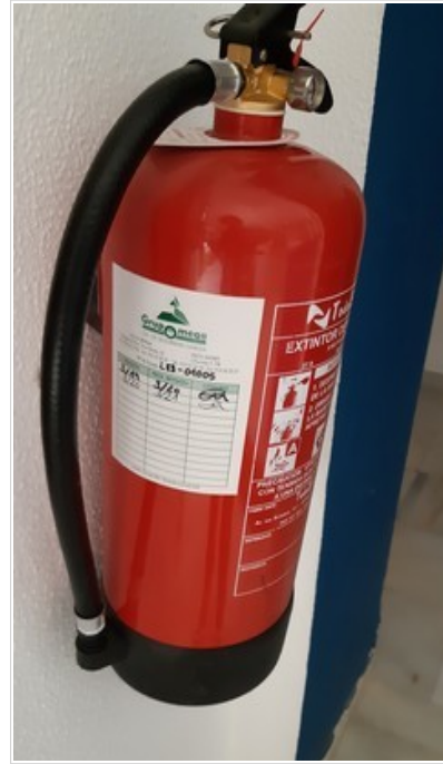
Fotografía n.º 16. Extintor
