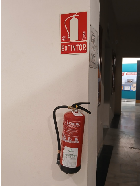
Fotografía n.º 17. Extintor
