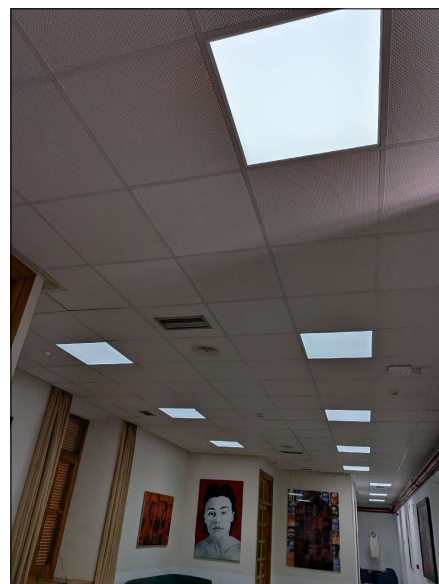
En planta baja las rejillas están colocadas horizontalmente en el falso techo
