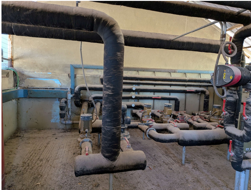
Foto 2: Conexión del ramal de ida que abastece las diferentes bombas de las dos plantas.
