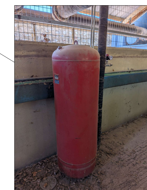
Depósito de inercia
