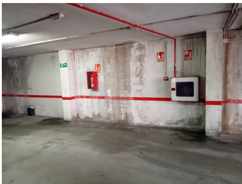
Fotografía de humedad en zona de garaje.
