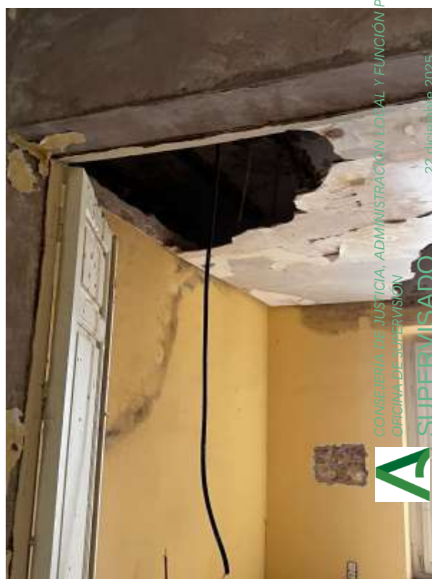
Cubierta de Casa Norte y desprendimientos de falsos techos en forjado de cubierta.
