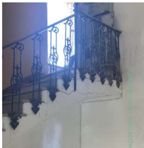
Grietas en el desembarco de la última meseta de la escalera de la Casa Sur
