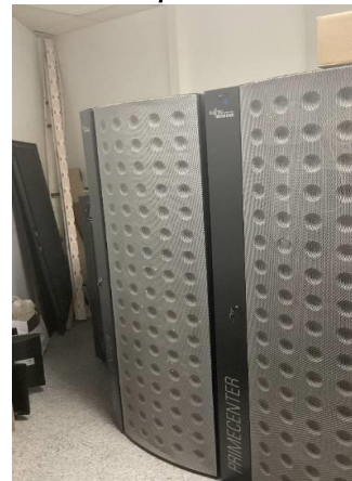
Ilustración 42 Rack Grande Planta 0 CPD/
