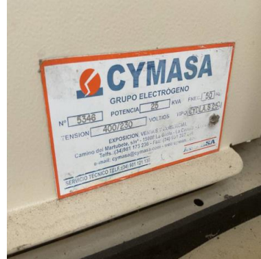
Ilustración 8 Placa de características del grupo electrógeno
