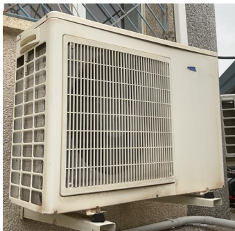
Ilustración 19 Unidad exterior sala teclistas
