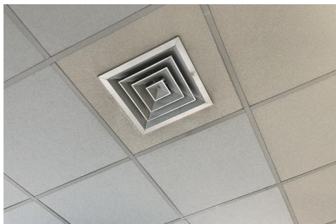
Ilustración 21 Unidad interior de los equipos Rooftop
