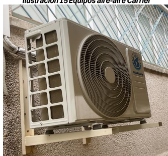
Ilustración 17 Unidad exterior equipo autónomo CPD
