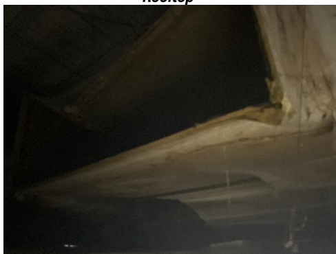
Ilustración 23 Estado de los conductos de climatización
