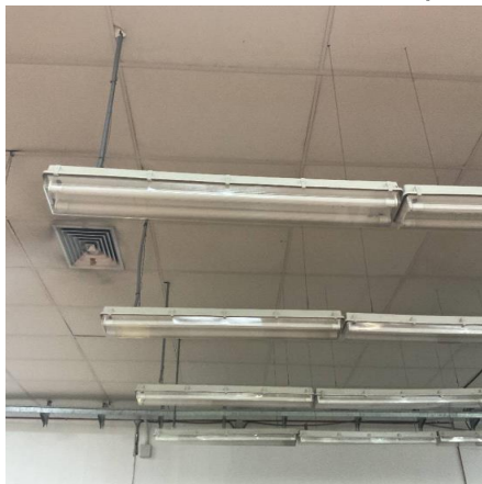
Ilustración 31 Luminaria Planta 0 Taller Imprenta
