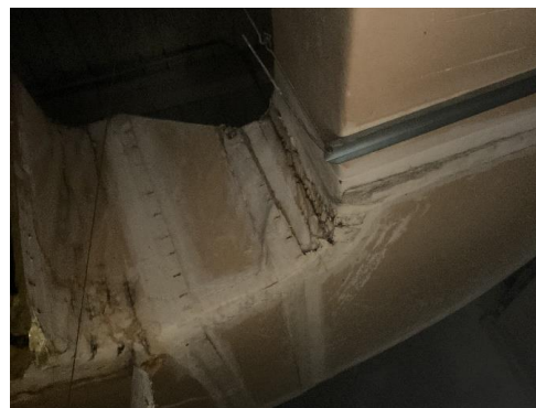
Ilustración 24 estado unión conductos de climatización
