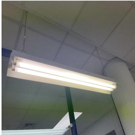
Ilustración 27 Luminaria Planta 0 Almacén
