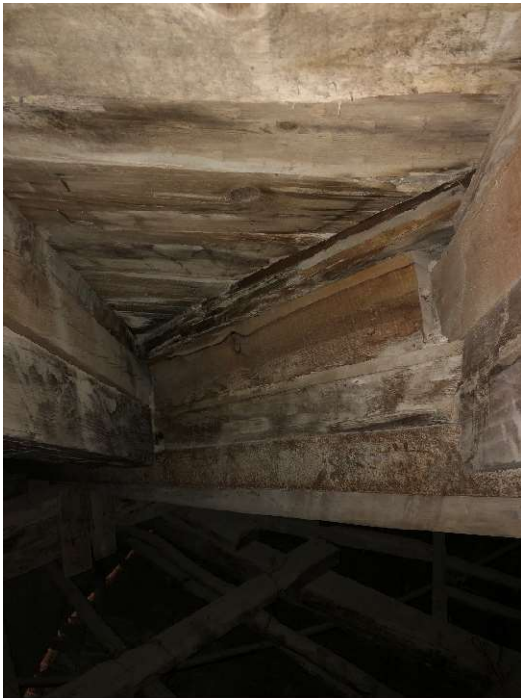
IMAGEN 9. Refuerzo oxidado en limatesa Este.
