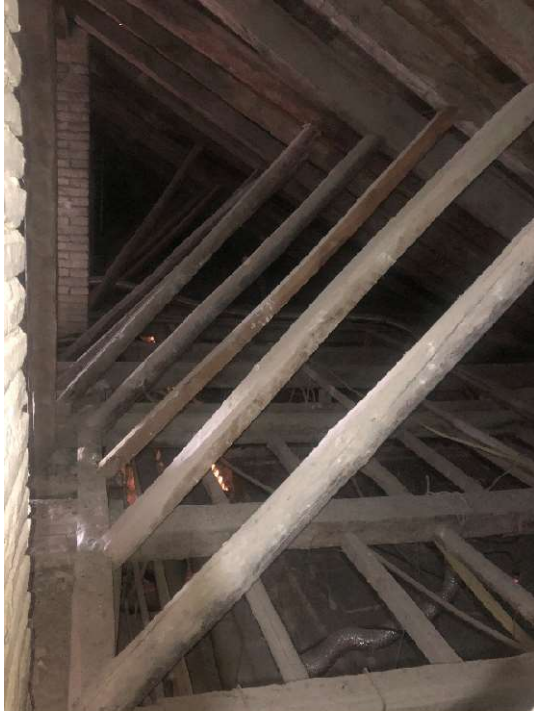
IMAGEN 1. Tornapuntas ala Sur.
