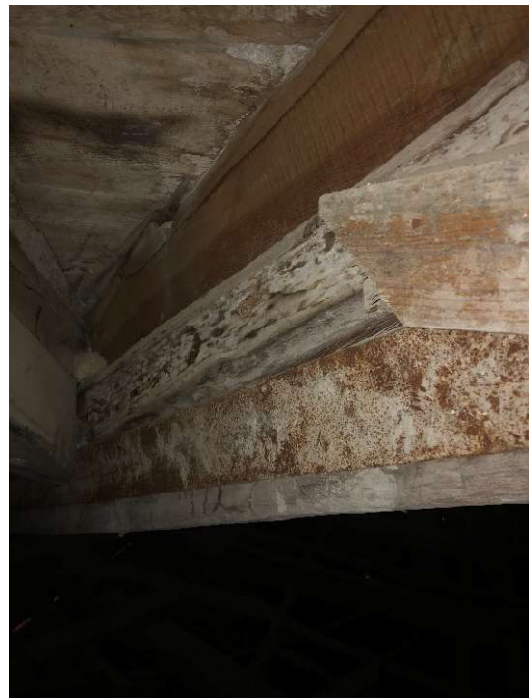
IMAGEN 14. Refuerzo oxidado de limahoya Este.
