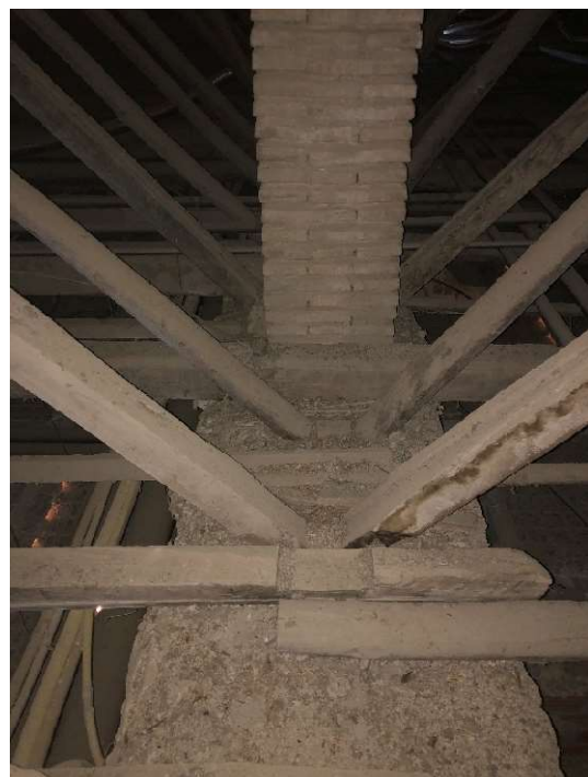
IMAGEN 20. Apoyo de tornapuntas sin durmiente.
