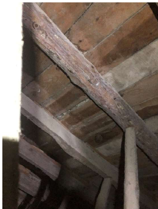
IMAGEN 4. Irregularidad de pares en cubierta
