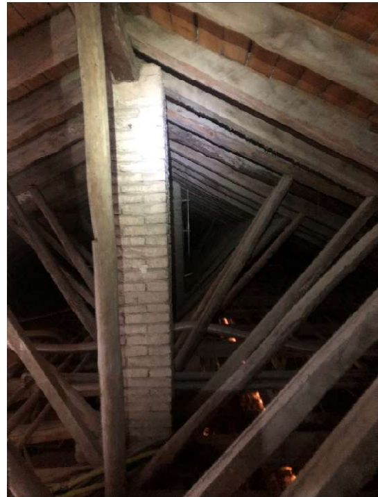
IMAGEN 2. Pie derecho y tornapuntas irregulares. Sur.
