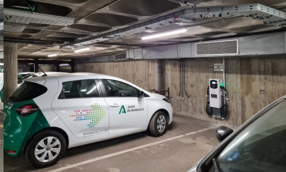
Conductos de extracción del Sótano -1
