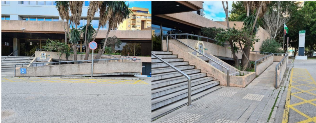
Rampa de acceso (acerado invadido por el primer tramo de la rampa)
