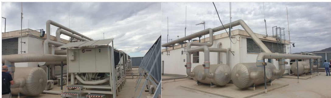
Unidades exteriores (enfriadora y bomba de calor)
