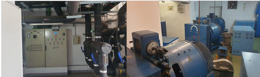
Sala de bombas de climatización
