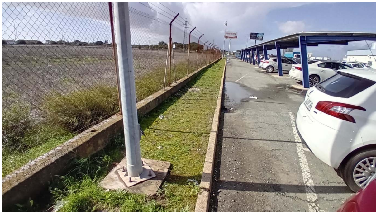
Imagen general de la instalación de alumbrado exterior
