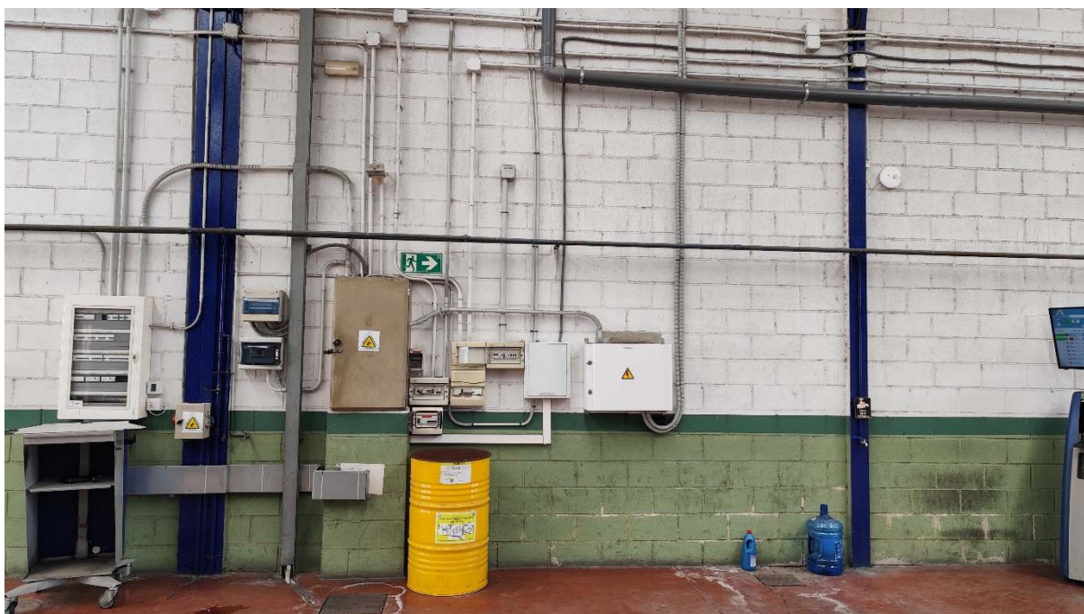
Vista general de la instalación eléctrica de la nave de inspección
