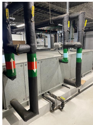
Foto 2. Equipos a sustituir
