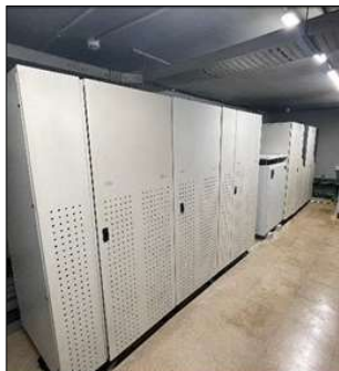
Foto 1. SAI 2x160 kVA. Edif. Expo
