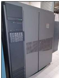
Foto 2. SAI 500 kVA. Edif. S-3
