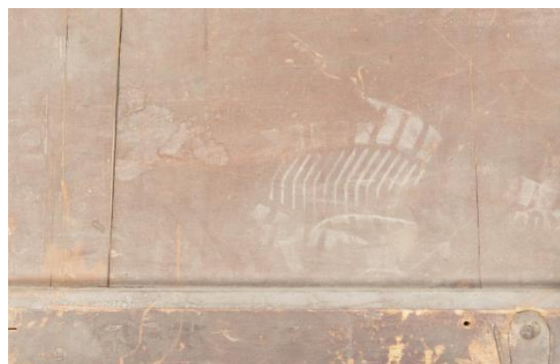
Acumulación de polvo y suciedad
