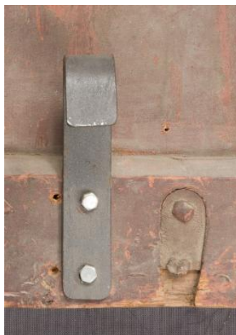
Sustitución y oxidación de metales
