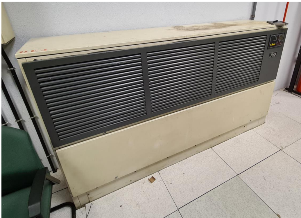
FOTO ROCA CONDENSADO POR AGUA
