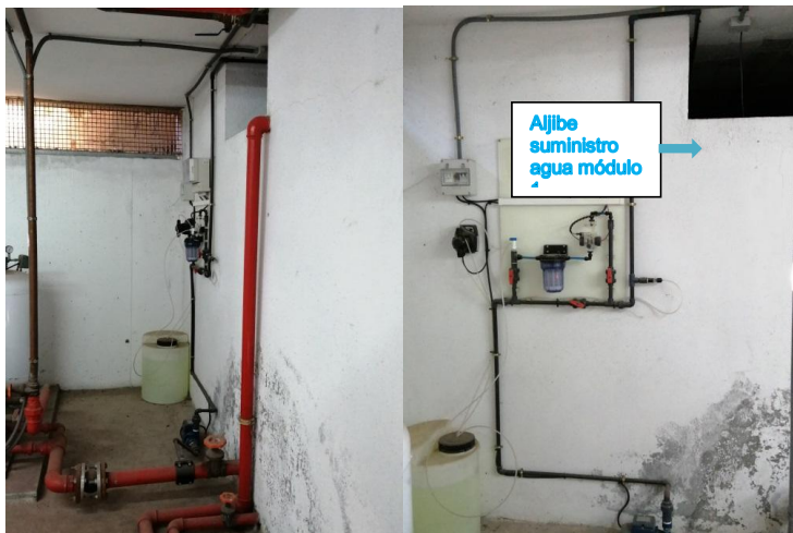
Equipo de cloración en aljibe de suministro de agua para módulo 1
