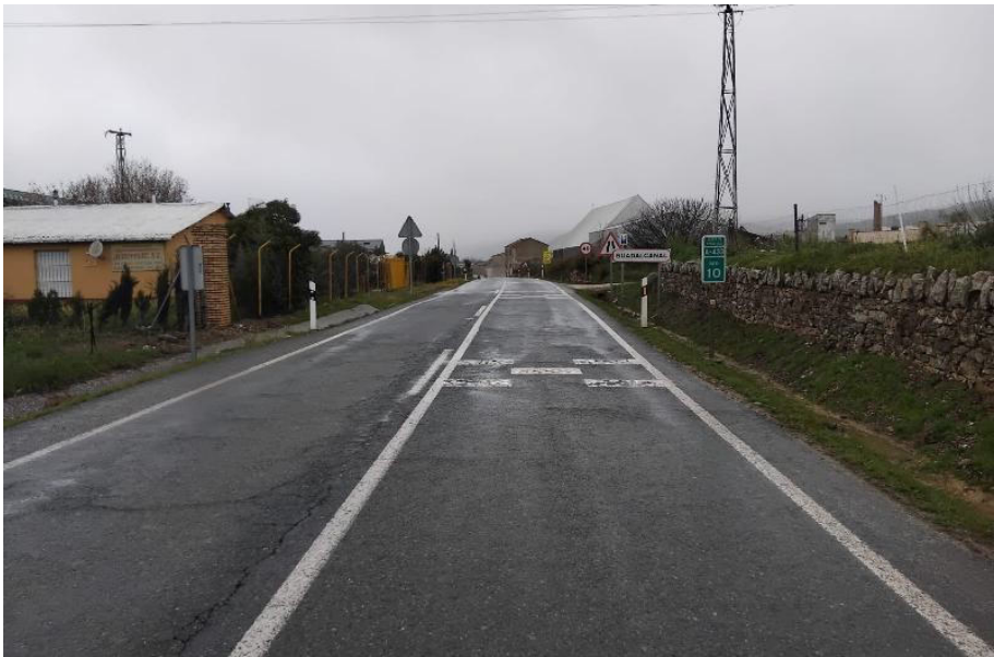
A-433 PPKK 0+000-10+490 ESTADO SEÑALIZACIÓN HORIZONTAL (12)
