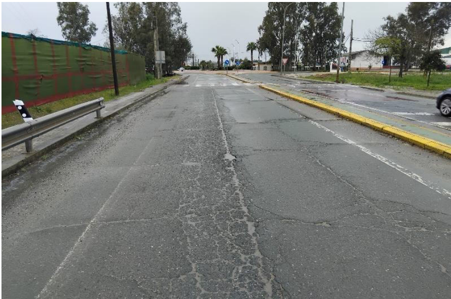
A-436 PPK 4+500-6+000 ESTADO SEÑALIZACIÓN HORIZONTAL (3)
