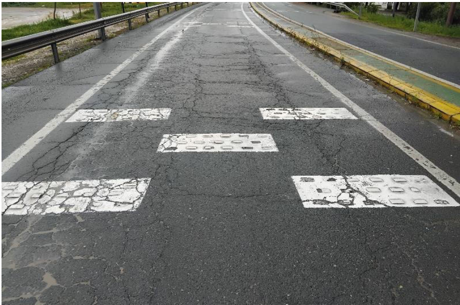
A-436 PPK 4+500-6+000 ESTADO SEÑALIZACIÓN HORIZONTAL (5)
