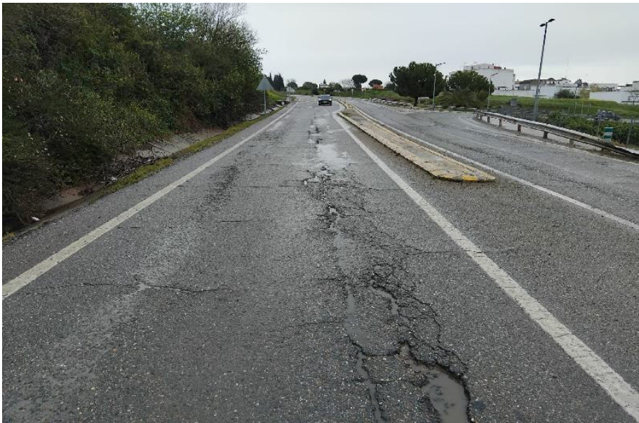
A-436 PPK 4+500-6+000 ESTADO SEÑALIZACIÓN HORIZONTAL (7)
