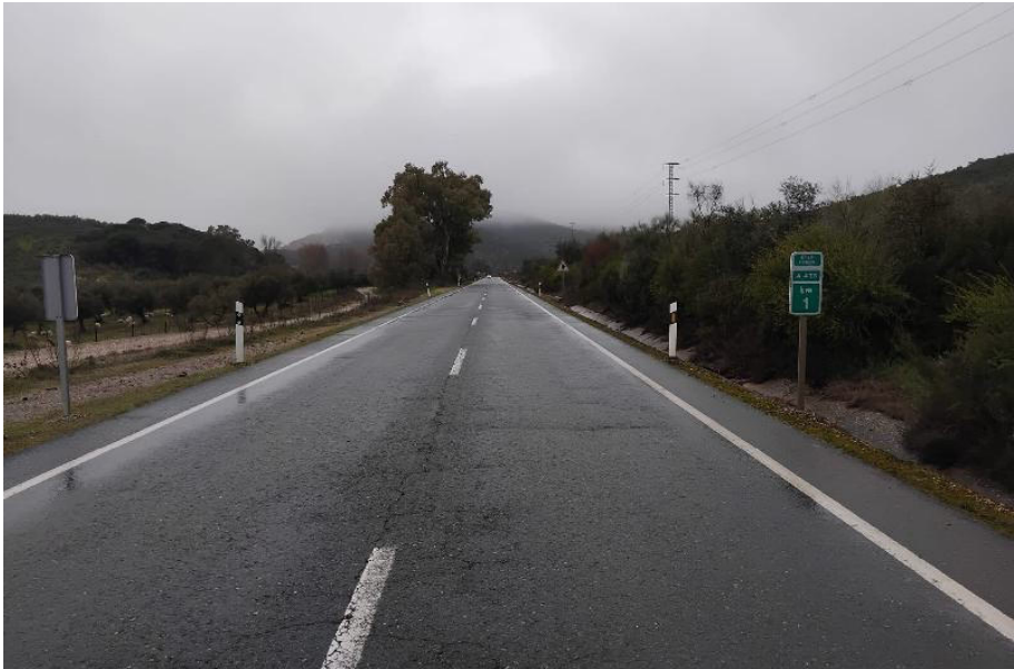
A-433 PPKK 0+000-10+490 ESTADO SEÑALIZACIÓN HORIZONTAL (2)
