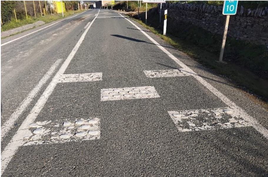
A-433 PPKK 0+000-10+490 ESTADO SEÑALIZACIÓN HORIZONTAL (13)
