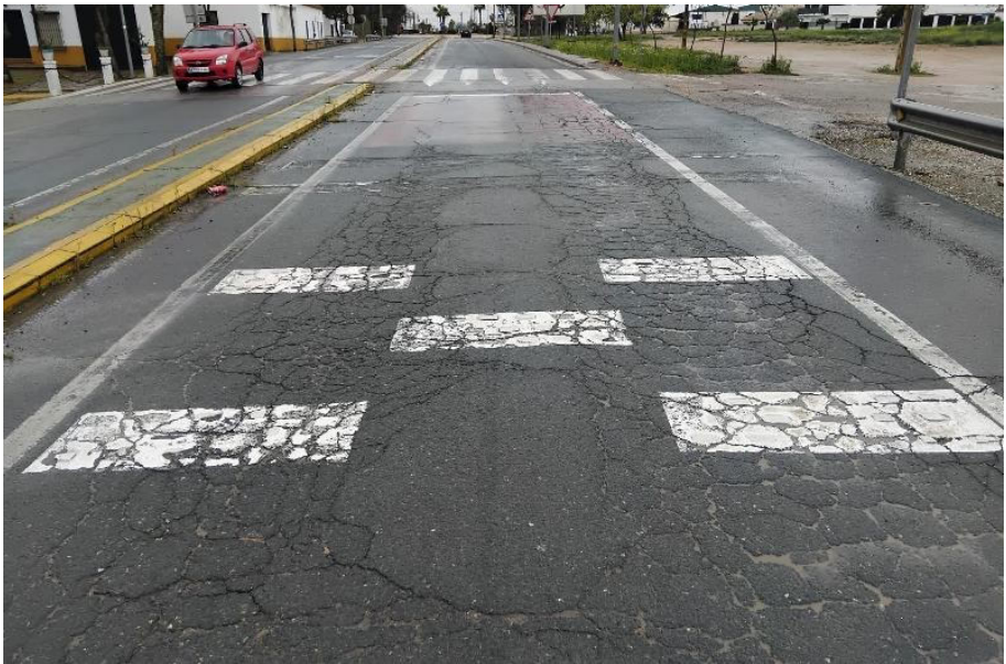
A-436 PPK 4+500-6+000 ESTADO SEÑALIZACIÓN HORIZONTAL (9)
