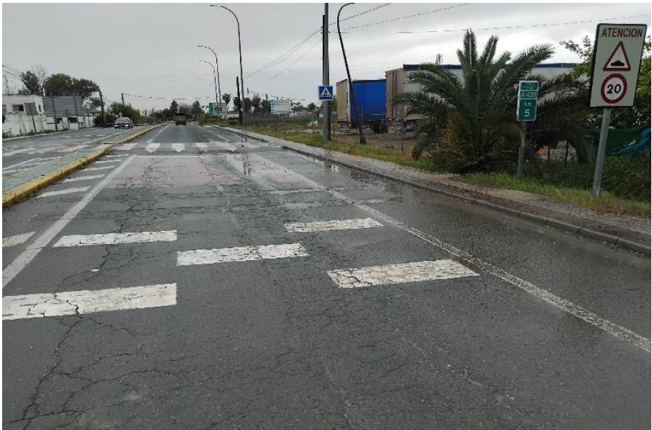
A-436 PPK 4+500-6+000 ESTADO SEÑALIZACIÓN HORIZONTAL (10)
