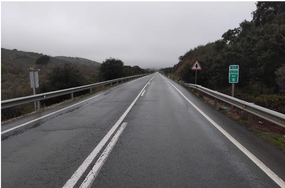
A-433 PPK 0+000-10+490 ESTADO SEÑALIZACIÓN HORIZONTAL (8)
