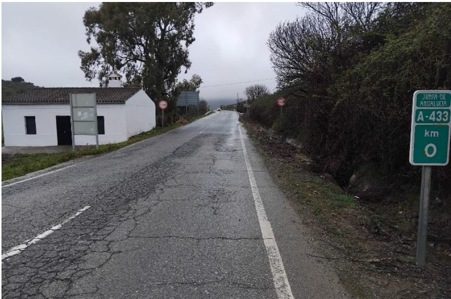
A-433 PPKK 0+000-10+490 ESTADO SEÑALIZACIÓN HORIZONTAL (1)
