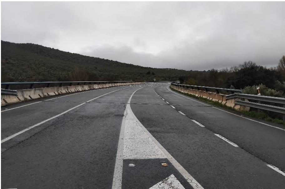
A-433 PPKK 0+000-10+490 ESTADO SEÑALIZACIÓN HORIZONTAL (4)
