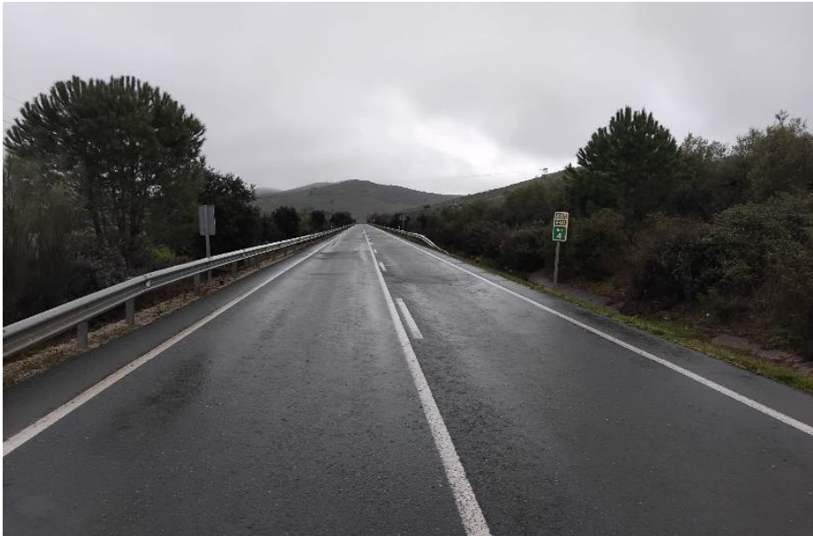
A-433 PPKK 0+000-10+490 ESTADO SEÑALIZACIÓN HORIZONTAL (6)
