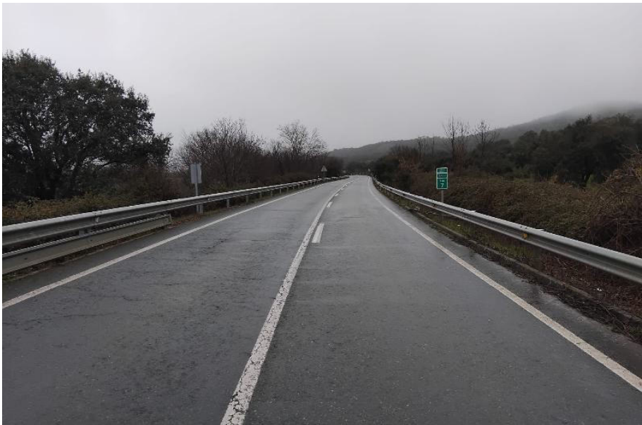
A-433 PPK 0+000-10+490 ESTADO SEÑALIZACIÓN HORIZONTAL (9)
