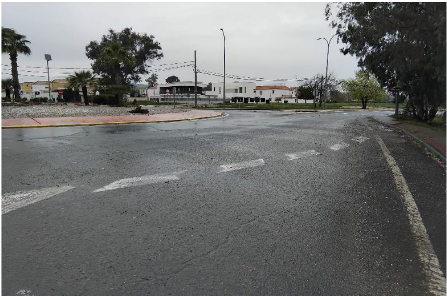
A-436 PPK 4+500-6+000 ESTADO SEÑALIZACIÓN HORIZONTAL (8)
