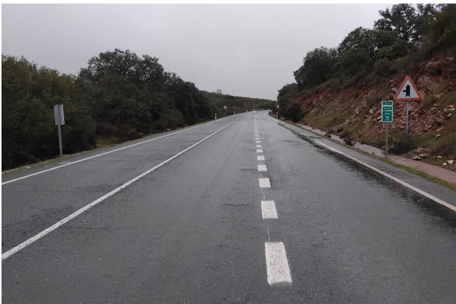
A-433 PPK 0+000-10+490 ESTADO SEÑALIZACIÓN HORIZONTAL (7)
