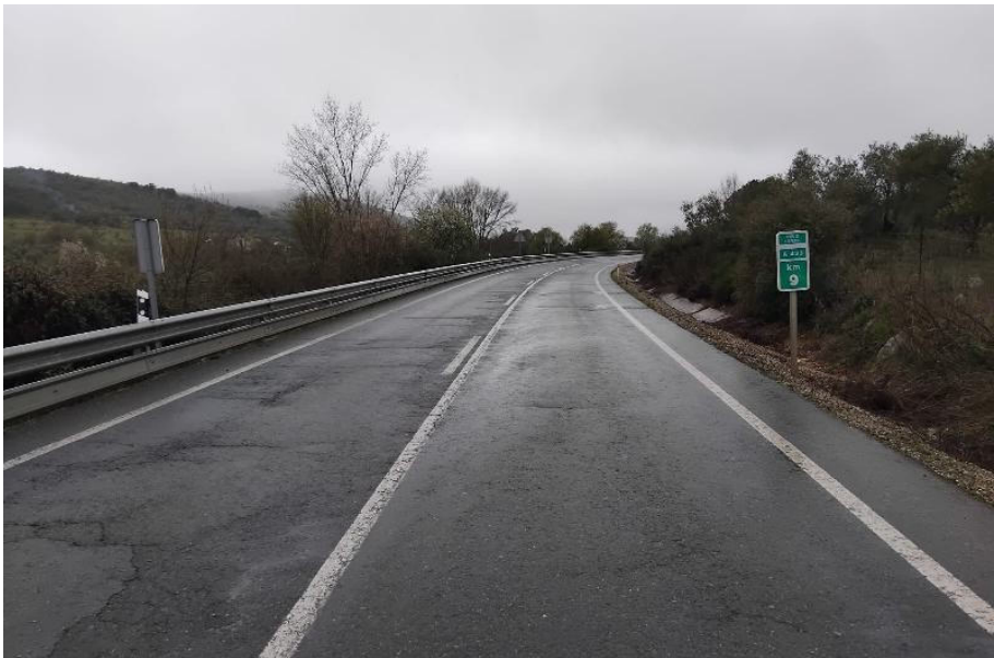
A-433 PPKK 0+000-10+490 ESTADO SEÑALIZACIÓN HORIZONTAL (11)
