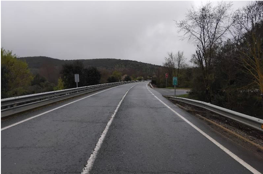
A-433 PPKK 0+000-10+490 ESTADO SEÑALIZACIÓN HORIZONTAL (3)
