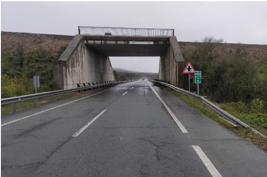
A-433 PPKK 0+000-10+490 ESTADO SEÑALIZACIÓN HORIZONTAL (10)
