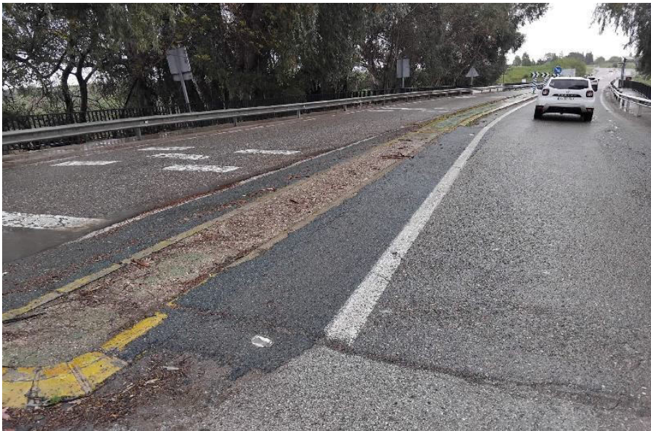
A-436 PPK 4+500-6+000 ESTADO SEÑALIZACIÓN HORIZONTAL (6)
