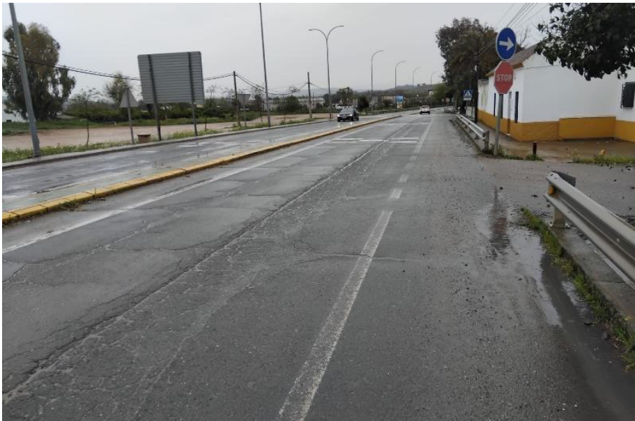
A-436 PPK 4+500-6+000 ESTADO SEÑALIZACIÓN HORIZONTAL (2)
