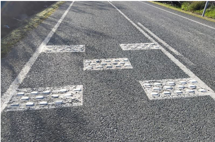
A-433 PPKK 0+000-10+490 ESTADO SEÑALIZACIÓN HORIZONTAL (14)
