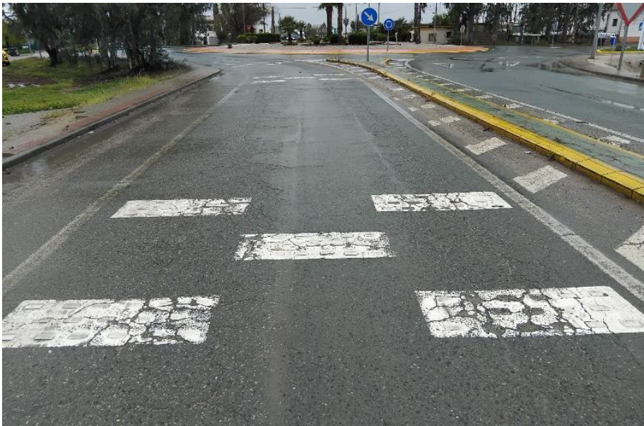
A-436 PPK 4+500-6+000 ESTADO SEÑALIZACIÓN HORIZONTAL (4)
