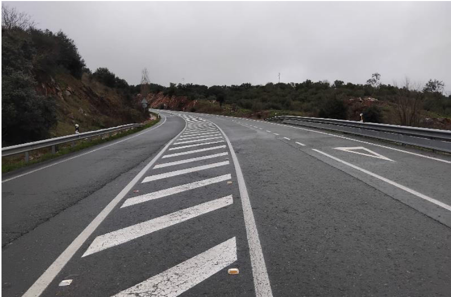
A-433 PPKK 0+000-10+490 ESTADO SEÑALIZACIÓN HORIZONTAL (5)
