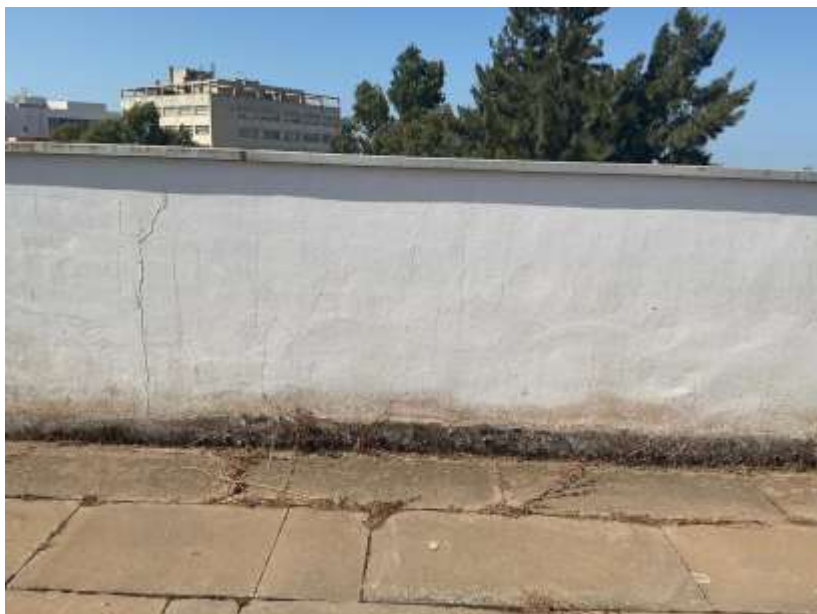
Levantamiento de enfoscado y humedades EN encuentro de peto con cubierta
