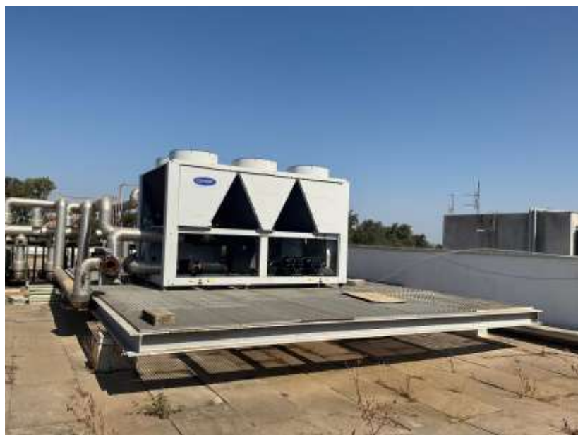
Impermeabilización deficiente en apoyos de plataforma de instalaciones
