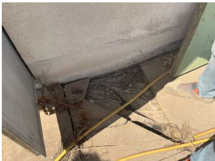
Desgaste y desprendimiento de lámina impermeabilizante existente y de losas filtrantes
