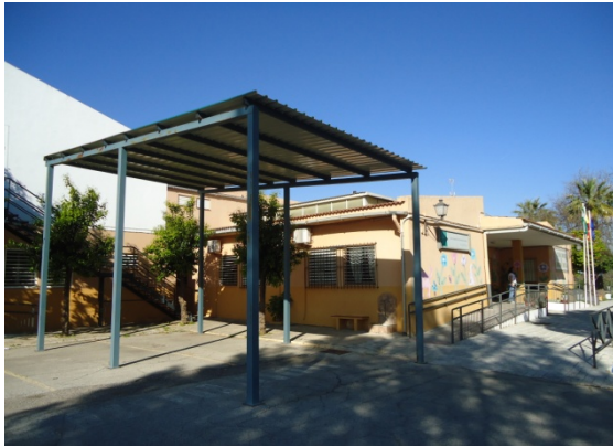
FOTO Nº 13: Filtraciones vuelo exterior
