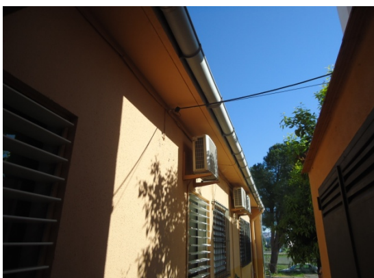
FOTO N° 17: Filtraciones vuelo exterior
