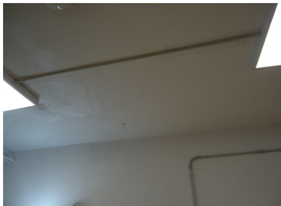
FOTO Nº 40: Filtraciones con desprendimiento Secretaría
