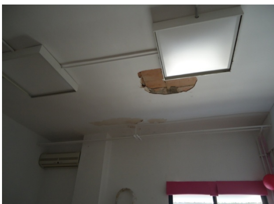
FOTO Nº 37: Filtraciones con desprendimiento Dirección
