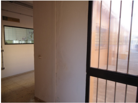
FOTO Nº 41: Filtraciones junta de dilatación
