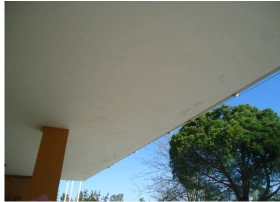
FOTO Nº 22: Filtraciones porche entrada
