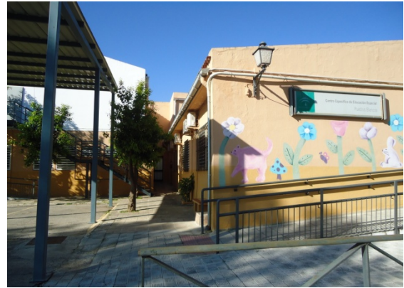
FOTO Nº 14: Filtraciones vuelo exterior
