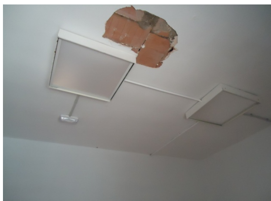
FOTO Nº 38: Filtraciones con desprendimiento Dirección
