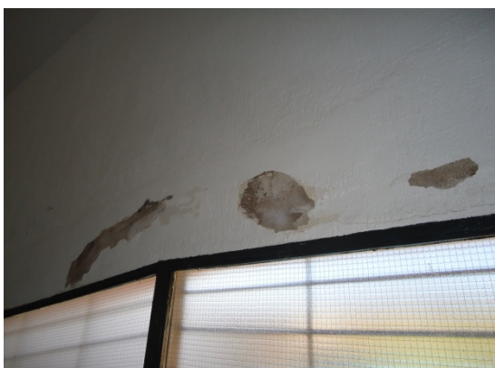
FOTO Nº 33: Filtraciones rampa interior
