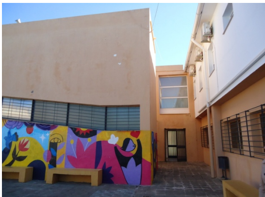
FOTO Nº 29: Filtraciones rampa interior
