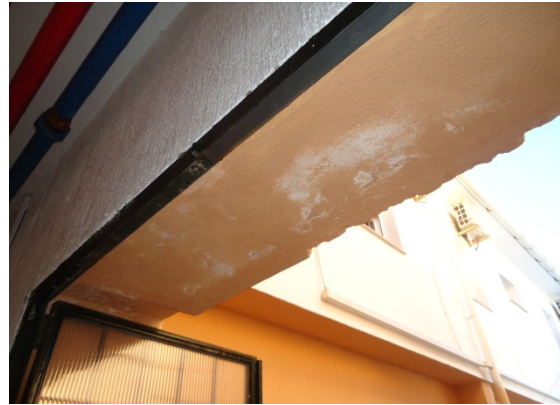
FOTO Nº 42: Filtraciones junta de dilatación
