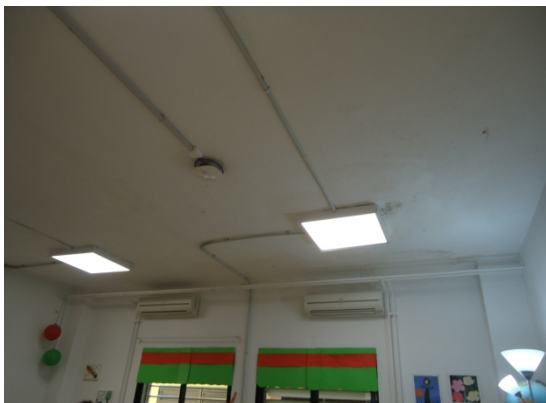
FOTO Nº 39: Filtraciones con desprendimiento Secretaría
