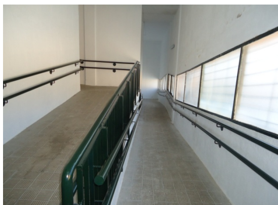
FOTO Nº 34: Filtraciones rampa interior
