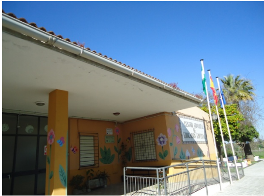
FOTO Nº 21: Filtraciones porche entrada
