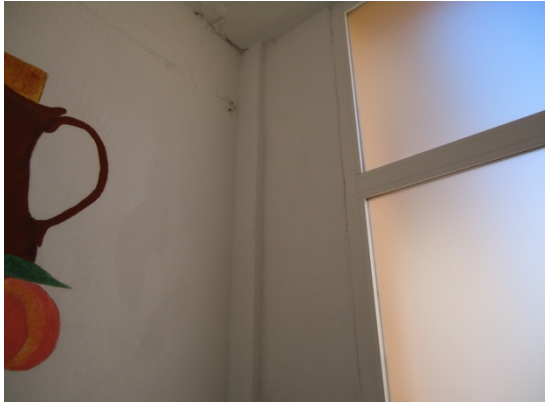
FOTO Nº 49: Filtraciones junta de dilatación
