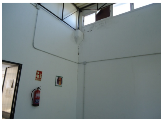
FOTO Nº 54: Grietas y fisuras en el SUM
