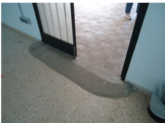
FOTO Nº 53: Grietas y fisuras en el SUM
