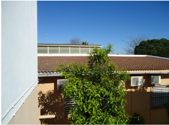
FOTO Nº 25: Cubierta de tejas deteriorada
