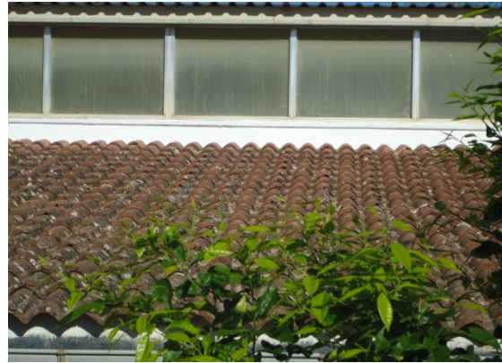
FOTO Nº 26: Cubierta de tejas deteriorada
