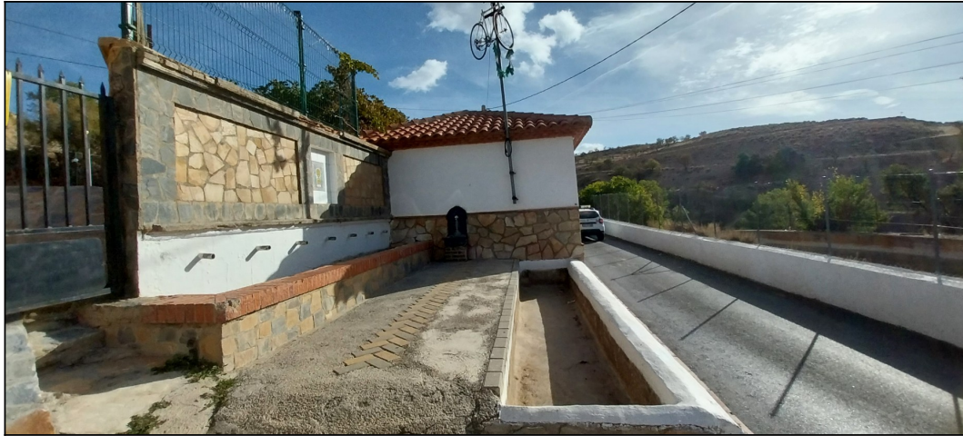
Fuente, lavadero y depósito sin caudal en Charches, a fecha de 15 de octubre de 2025
