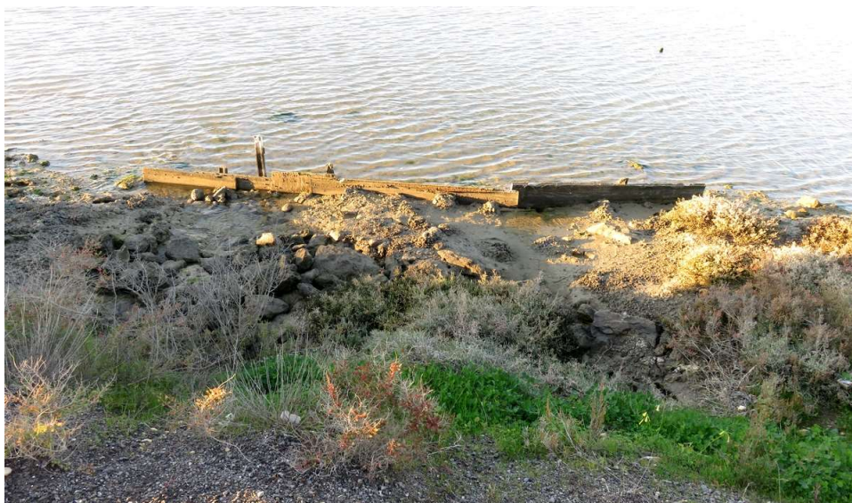
Foto 10. Imágenes del estado de conservación en zonas próximas a la vuelta de fuera. Arriba: filtraciones de agua del caño (conocidas como "cangrejeras") y abajo, pantalla de protección del estero frente a estas filtraciones. Es necesario reparar y conservar la vuelta de fuera para asegurar el mantenimiento de su estructura y funcionalidad.
