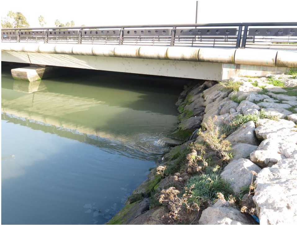
Foto 7. Vertido de aguas fecales en la zona próxima al puente del molino de mareas ubicado en Zaporito. Fotografía realizada el 9-1-19.
