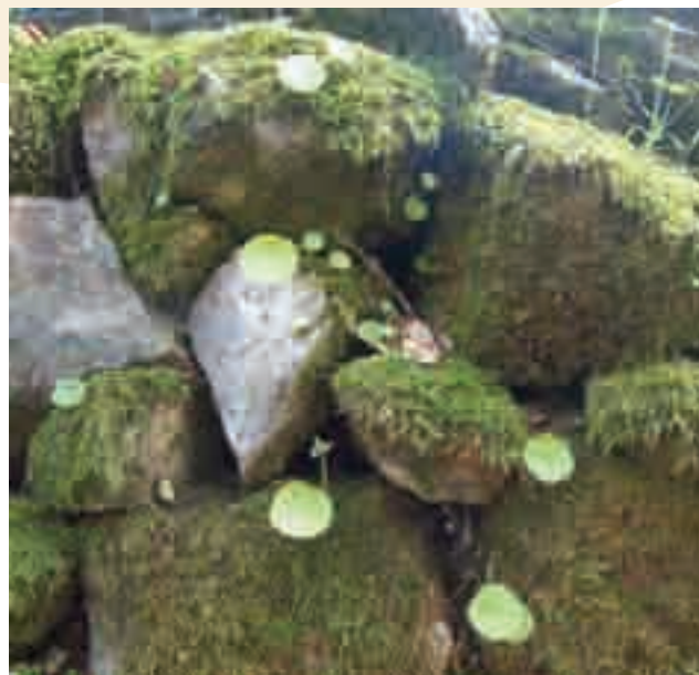
Muro con vegetación rupícola Mur avec végétation rupicole
