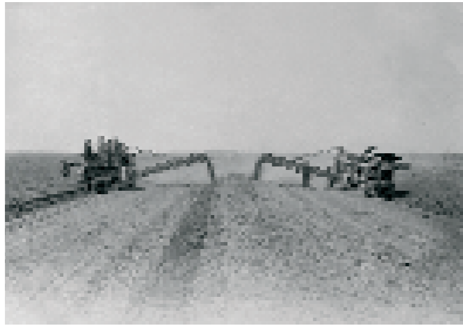
Construcción del muro de contención de Los Pobres Marismas del Guadalquivir, 1927-1930. Colección González Arteaga.
