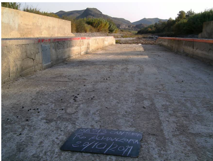
Figura 19. Estación de aforos de Cantoria (20/10/2011)
