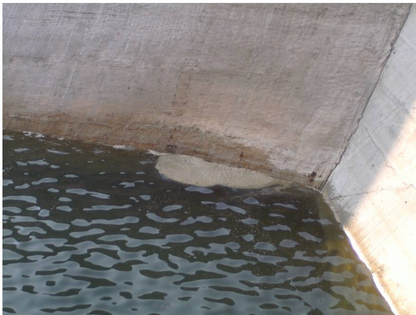
Figura 2. Espuma acumulada en una esquina del muro del Embalse de Rules (04/10/2011).
