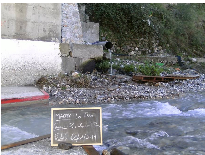
Figura 7. Vertido de aguas residuales al río de la Toba (12/01/2011).
