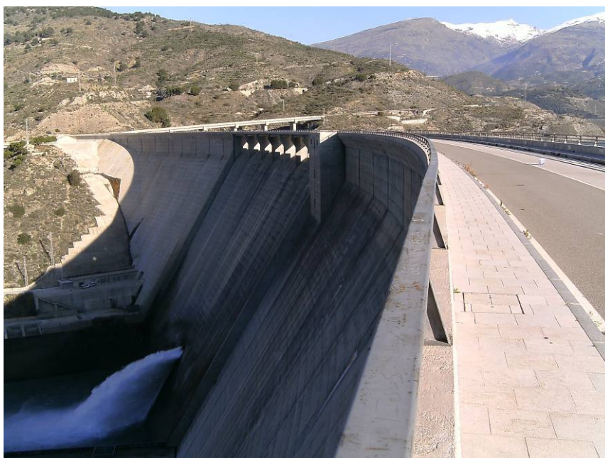
Figura 9. Muro del Embalse de Rules (14/02/2011)
